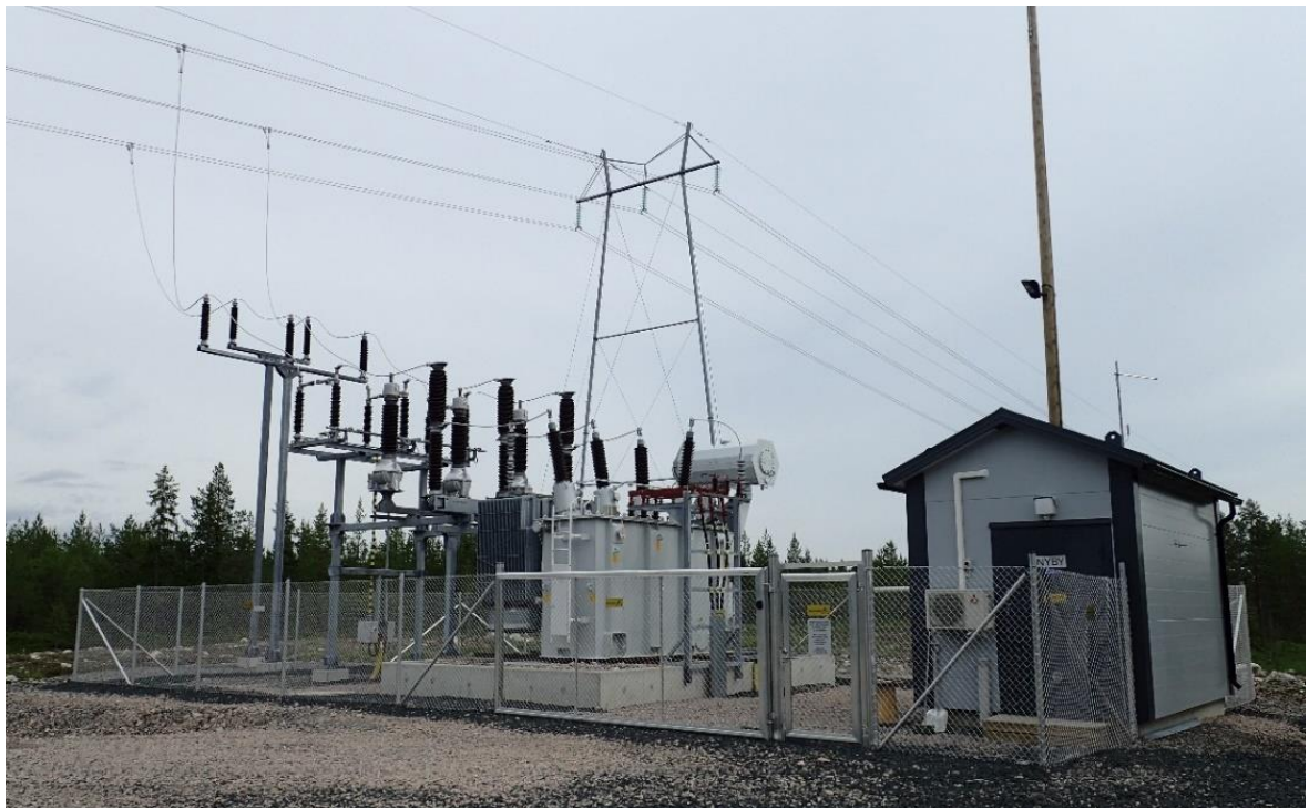
Kuva 2.18. Esimerkki tuulivoimapuiston sähköasemasta.
