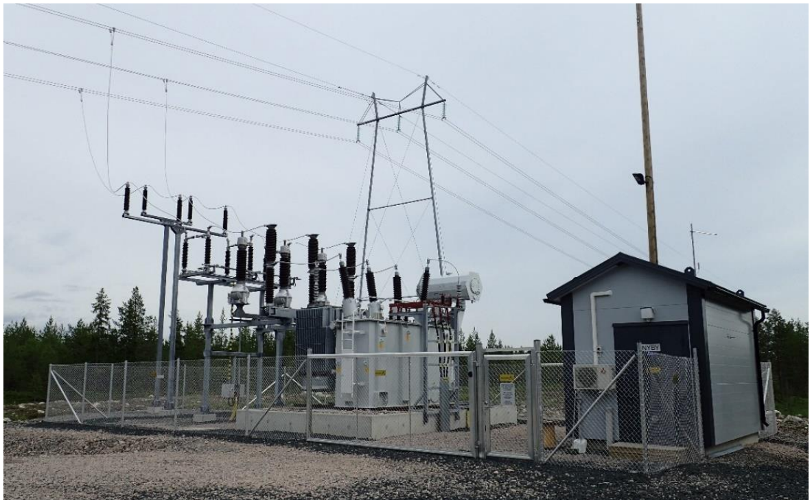
Kuva 2.18. Esimerkki tuulivoimapuiston sähköasemasta.
