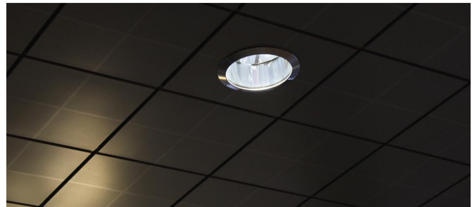
Modulaarisuus pintamateriaaleissa hahmottuu parhaiten aulassa. Alakatto on uusittu peruskorjauksen yhteydessä samankaltaiseksi kuin alkuperäinen.
