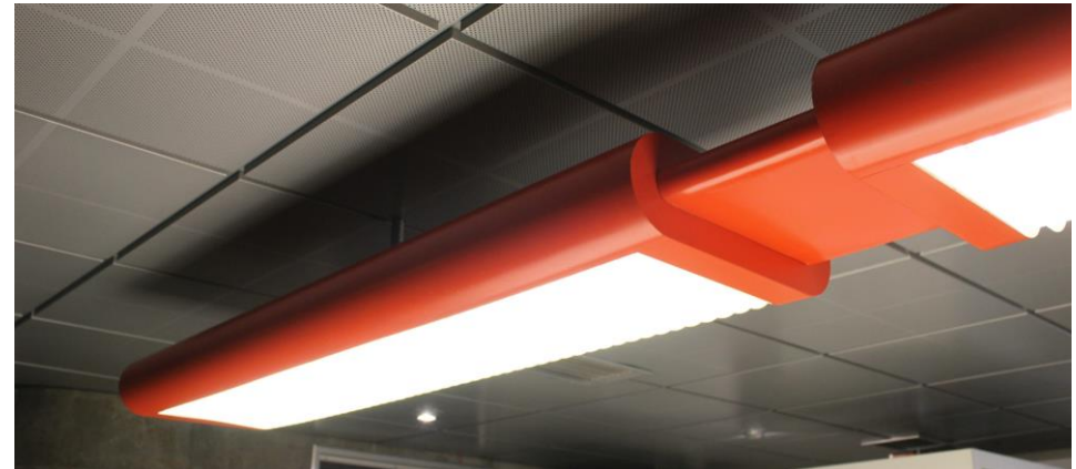
Pienen näyttämön lämpiön valaisimet ovat alkuperäiset. Vaatesäilytystilan kalusteet on peruskorjauksen yhteydessä uusittu.
