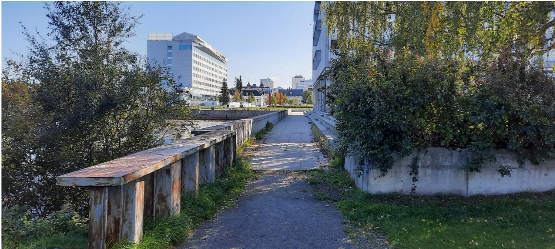
Kuva 38. Vänmanninsaaren rakenteissa on paikoitellen nähtävissä korjausta sekä tehokkaampaa hoitoa vaativia kohteita. Kuvauspiste 30.
