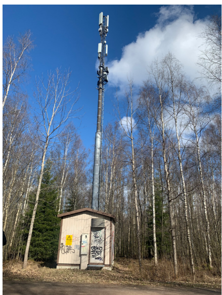
Kuva 12. Muuntamo ja masto kävely- ja pyöräilyväylän varrella. Taustalla lehtipuuvältaista, tiheää metsikköä.
