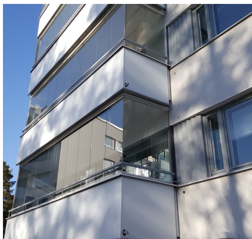
Parvekelasituksissa pitää huomioida lasituksen vaikutus mahdolliseen palon leviämiseen. Erityisesti räystääiden ja viereisten huoneistojen ikkunaukkoja on tarkasteltava.
