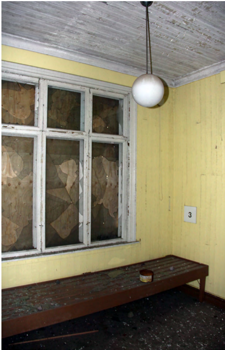
137. Alkuperäiset rakennusosat ovat paksujen maalikerrosten peittämiä.
