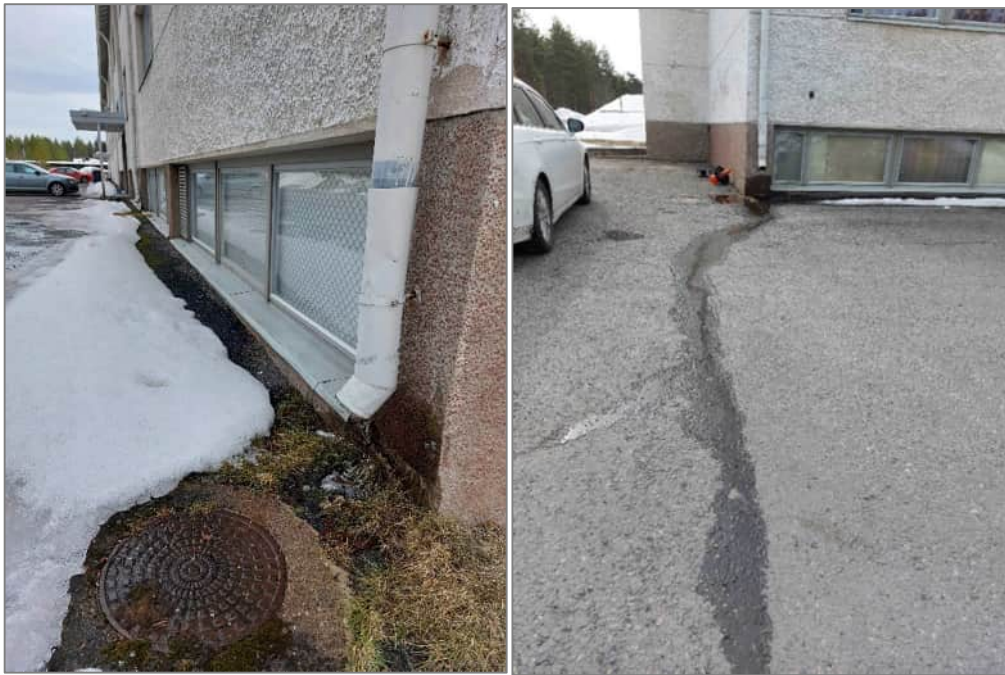
Kuva 11 Usean rakennuksen kattovedet johtuvat pintoja pitkin ympäristöön
