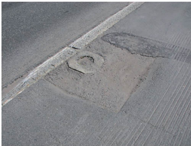
Kuvat 4 ja 5. Kevyen liikenteen väylä huonossa kunnossa Valtatien itä- ja Koskitien länsipuolella.
