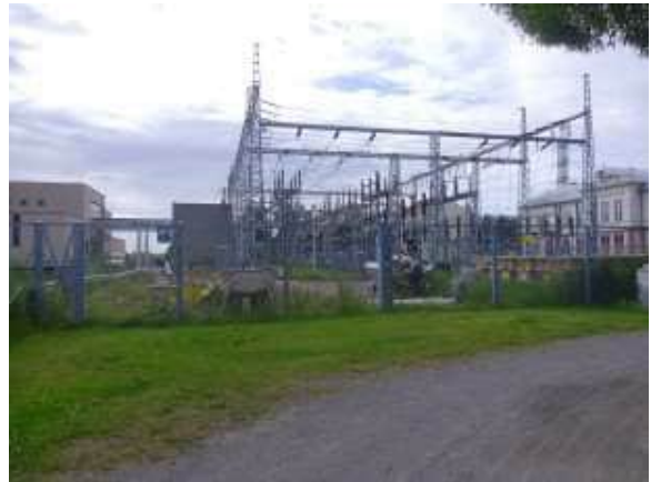
Kuva 18. Muuntajakenttä on maisemahäiriö.
