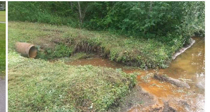
Kuva 116. Eroosiovaurioita Kaupunginojan varressa Kontinkankaalla.
