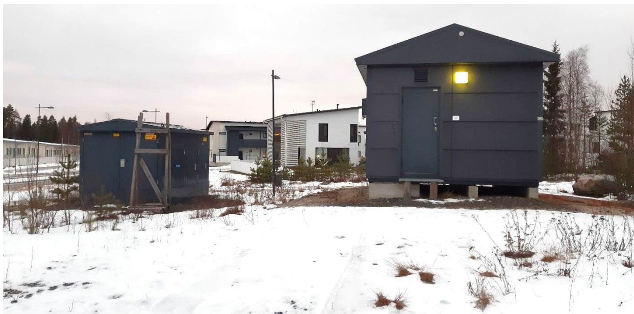
Kuva 5 Asemakaavan muutosalueen lounaisosassa sijaitsee muuntamo (oikealla) sekä operaattorin laiteteila (vasemmalla).
