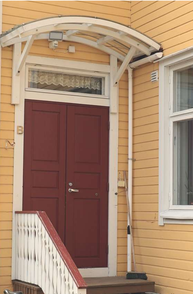
Kuva 42: 1920-luvun klassismi. Ovet on uusittu alkuperäisen mukaisina, katos on uusi lisäys. (Kuva: Riitta Kosonen, Arkkitehtitoimisto Jorma Teppo Oy, 5/2021.)
