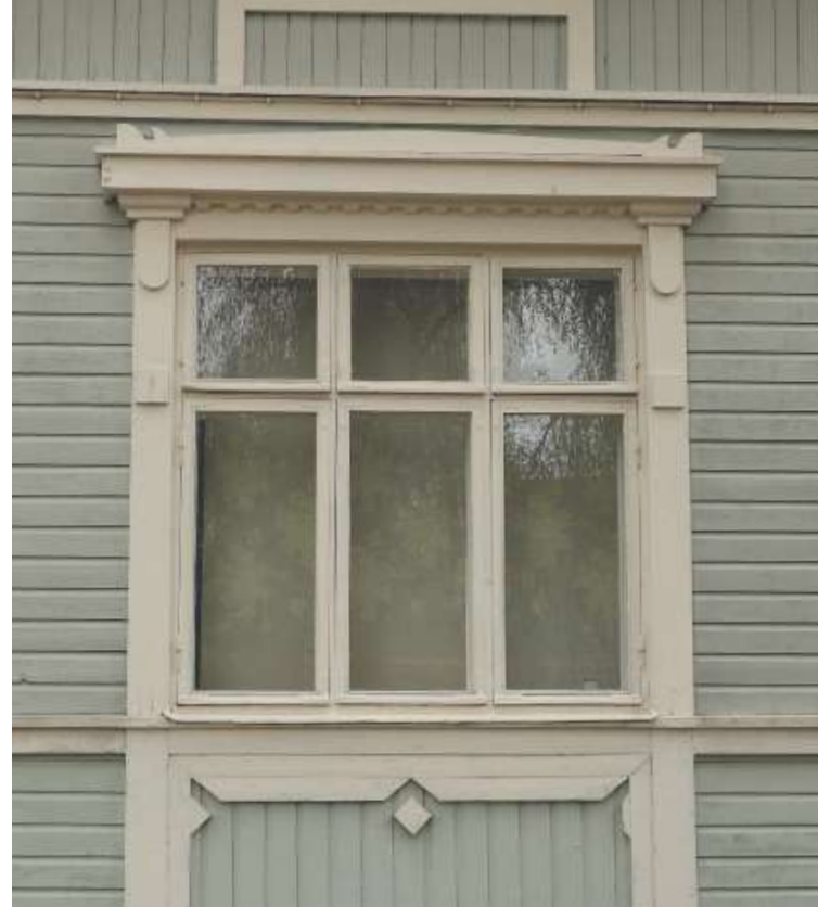
Kuva 39: Vanhimmissa puutaloissa ikkunoiden koristelistoitukset ovat runsaita. (Kuva: Riitta Kosonen, Arkkitehtitoimisto Jorma Teppo Oy, 5/2021)
