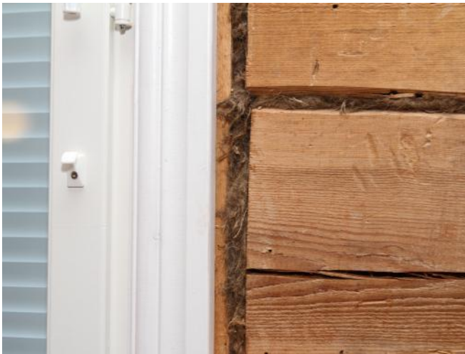
Ikkunan liitos hirsiseinään on vaikea saada tiiviiksi.
