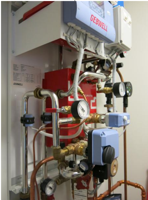
Juuri uusittu kaukolämmön lämmönvaihdin
