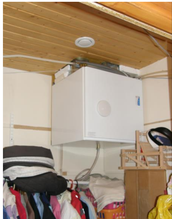
Korjauskohteessa ilmanvaihtokone voidaan sijoittaa esimerkiksi vaatehuoneeseen.
