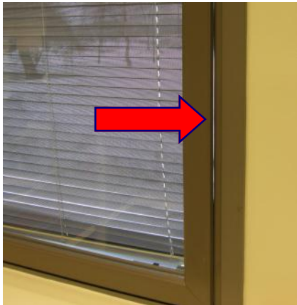
Hyvän ikkunan tiiveys voidaan pilata huonolla asennuksella.
