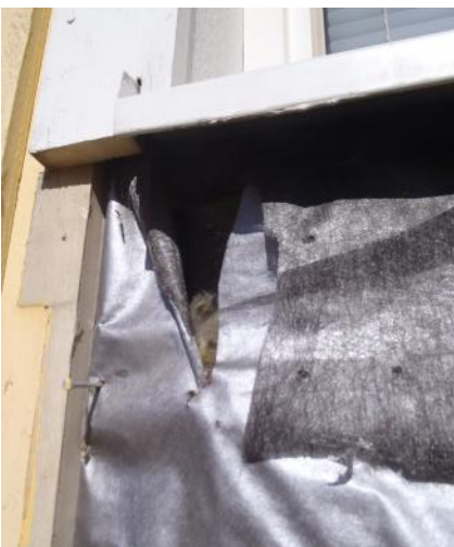
Jo asennusvaiheessa rikottu tuulensuojakalvo ja siitä aiheutuneen ilmapuodon jäljet eristeessä
