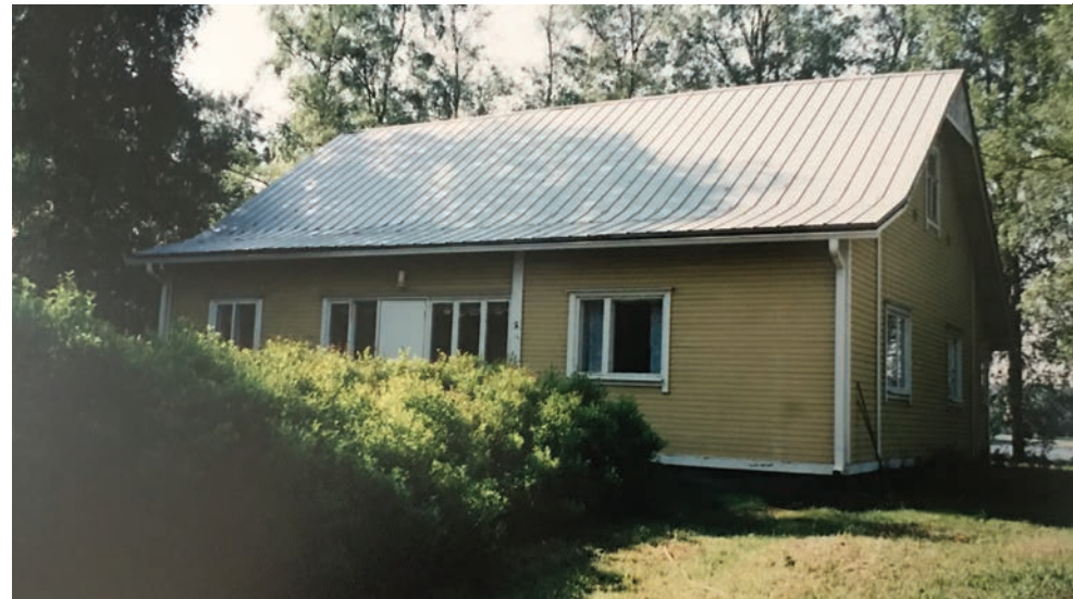
Kuva 80. Jokirinne, päärakennus tieltäpäin kuvattuna. Piippu on purettu. Villa Långin yksityiset kuva-arkistot. Vuosi ei tiedossa
