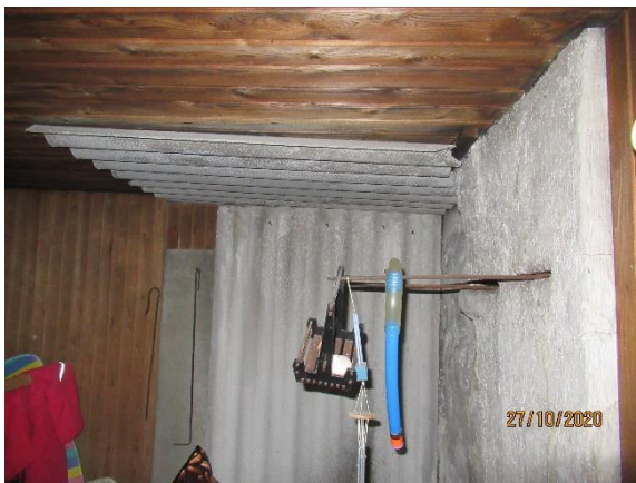
Näyte 1. Mineriittilevy sisältää asbestia. Mineriittilevyä on seinällä ja alakatossa yhteensä noin 4 m 2 .
