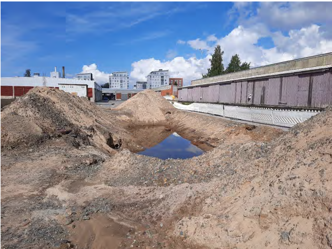
Kuva 2. Vedellä täyttynyt kaivanto (3.8.2020).
