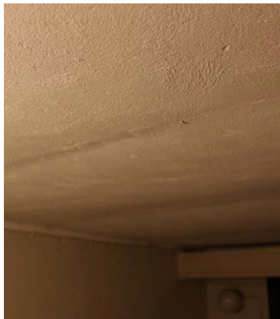
287. Itäpäädyssä kellarin alakatto on rapattu pehmeän toja-eristeen alapintaan. Levyt ovat loivasti notkolla.
