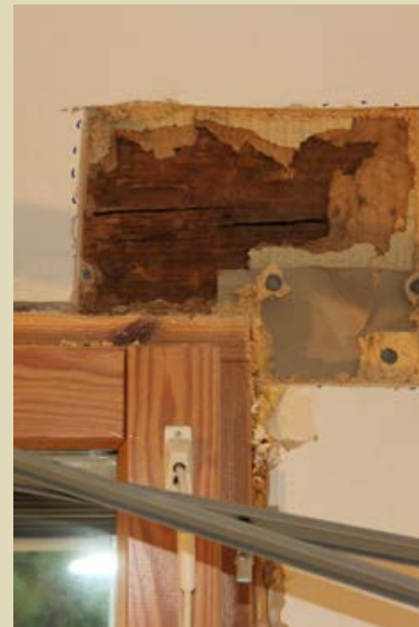
153. Ikkunan yläpuolella on vaakahirsi. Kuvassa näkyy myös tapettikerrostumia, joiden päälle on asennettu kipsilevy.
