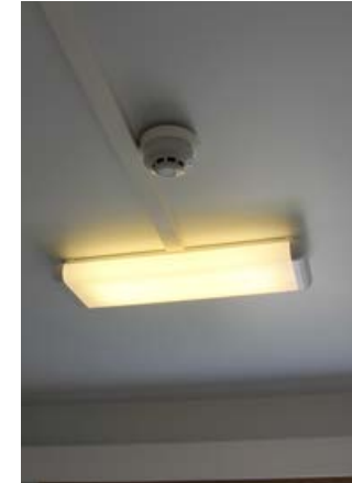
200. Yhden hengen huoneen yleisvalaisin katossa.
