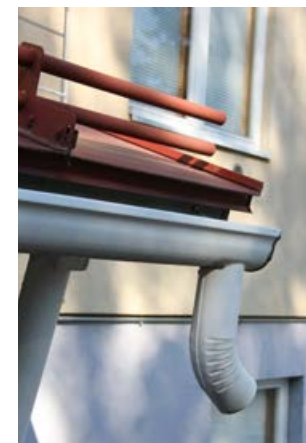
125. Koskitien puolella sadevesi johdetaan katolta maaperään.
