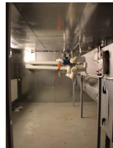
278. Ilmanvaihtokonehuone on rakennettu kellarisiin vuoden 1996 peruskorjauksessa.
