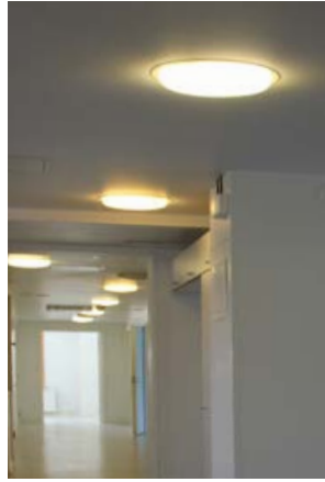
197. Käytävän suora valaistus on toteutettu kupuvalaisinten ketjulla.
