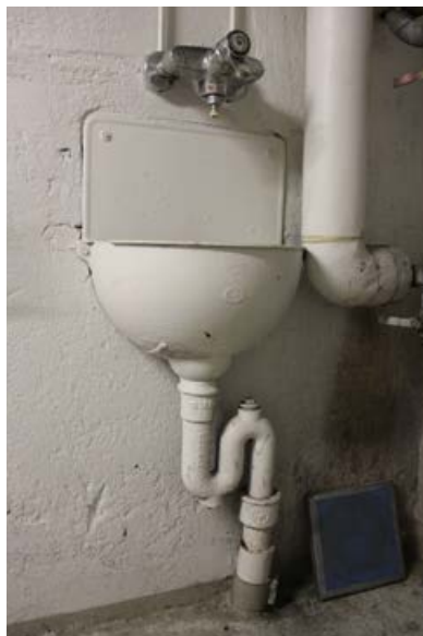
268. Lämpökeskuksessa on säilytetty mahdollisesti alkuperäinen Högforsin kaatoallas.
