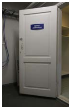
177. Alkuperäinen 1930-luvun ovi suojaa sähköpääkeskusta.
