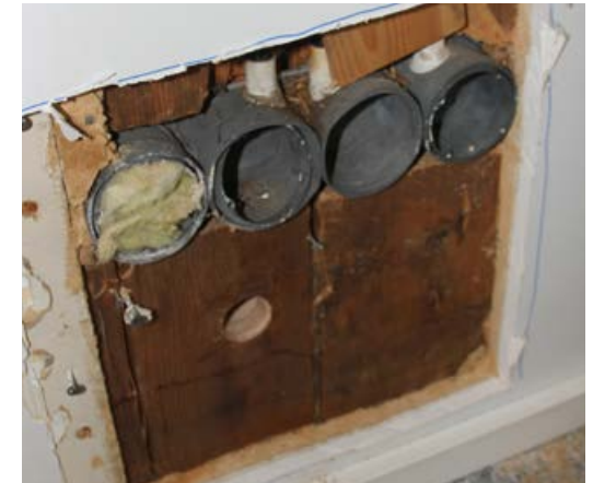
204. Vanhoja lyijykuorisia jakorasioita ulkoseinässä.
