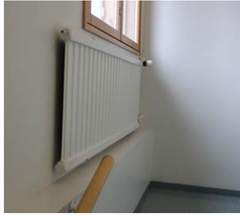
212. 1950-luvun vankkarakenteinen radiaattori porrashuoneessa.
