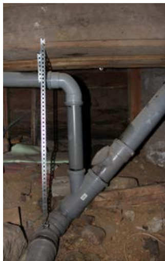
282. Uusittuja viemäriputkia ryömintätalassa. Putkia ei ole eristetty.
