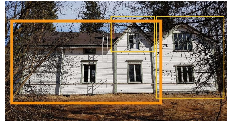
Julkisivu etelään. Vanhin, hirsirakenteinen osa on esitetty kuvassa oranssilla rajauksella. Keltaisella rajatut ovat myöhempiä laajennuksia ja muutoksia.
