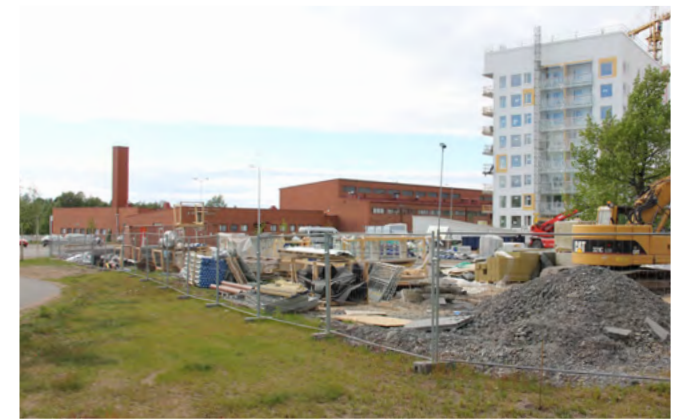
8. Näkymä Koskitien länsipäästä, jossa ajorata Kaupunginvarikon suuntaan on katkaistu. Oikealla näkyy rakenteilla oleva Lipporannan kortteli.
