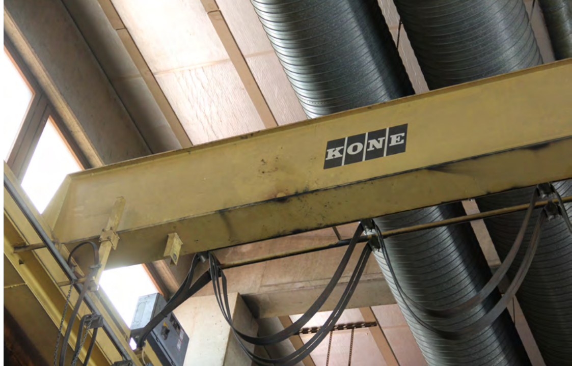
150. Korjaamon käytössä on päästä päähän kulkeva siltanosturi.
