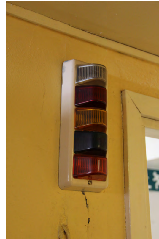
112. Liikennevalo kertoi, missä huoneessa lankapuhelin soi.
