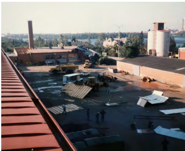
91. Vesikatto vuoden 1985 myrskytuhojen aikaan. Huoltohallin katto ja sen rakenteet jouduttiin uusimaan kokonaisuudessaan.
