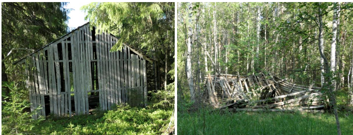
Kuva 8. Selvitysalueen eteläosassa on kaksi vanhaa latoa, joista toinen on romahtanut.
