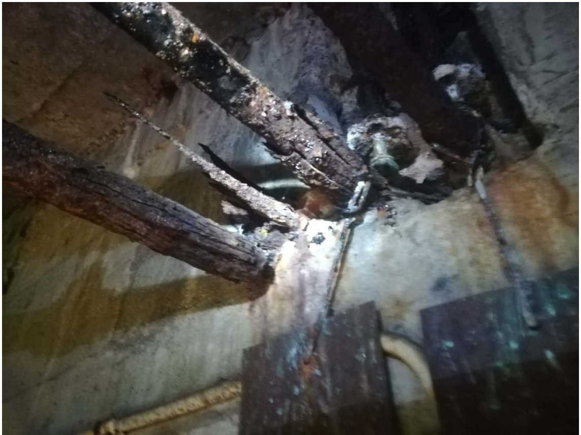
Kuva 6. Ruostuneita putkia, jotka menevät öljysäiliöön.
