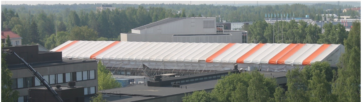
Sääsuojauksella vähennetään kosteudesta aiheutuvia riskejä sekä vähennetään työmaan säähäiriöitä ja kohotetaan työtehoa.
