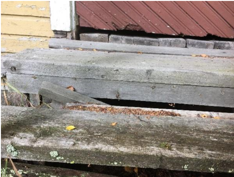
Kuva 4. Mahdollinen suojapaikka Ravanderin huvilan pihapiirissä olevan varastorakennuksen portaiden alla sekä sisäänpääsypaikka rakennukseen.
