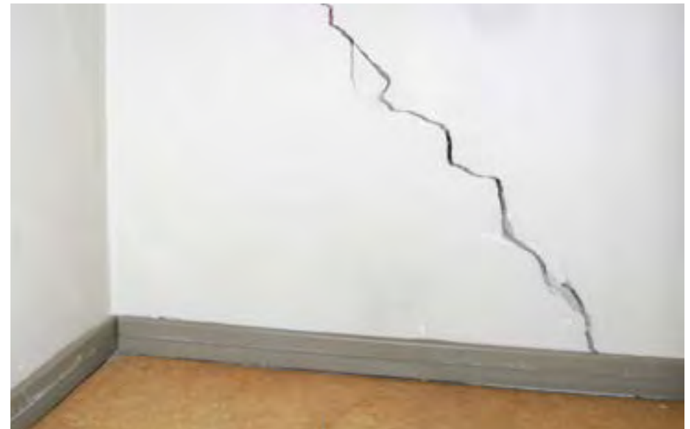
92. Juhlasalisiiven julkisivussa nähtävä, ilmeisesti perustuksen pettämisestä johtuva pitkä halkeama on havaittavissa myös sisätilassa.
