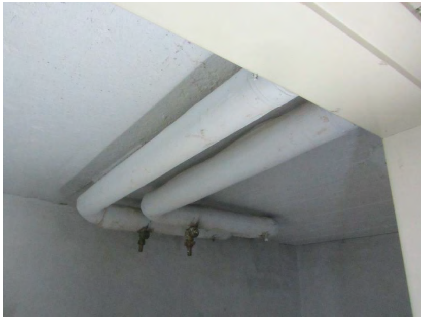
Kuva 5. Itäpäädyn kellarin katon rajassa kulkevia asbestieristettyjä putkia.
