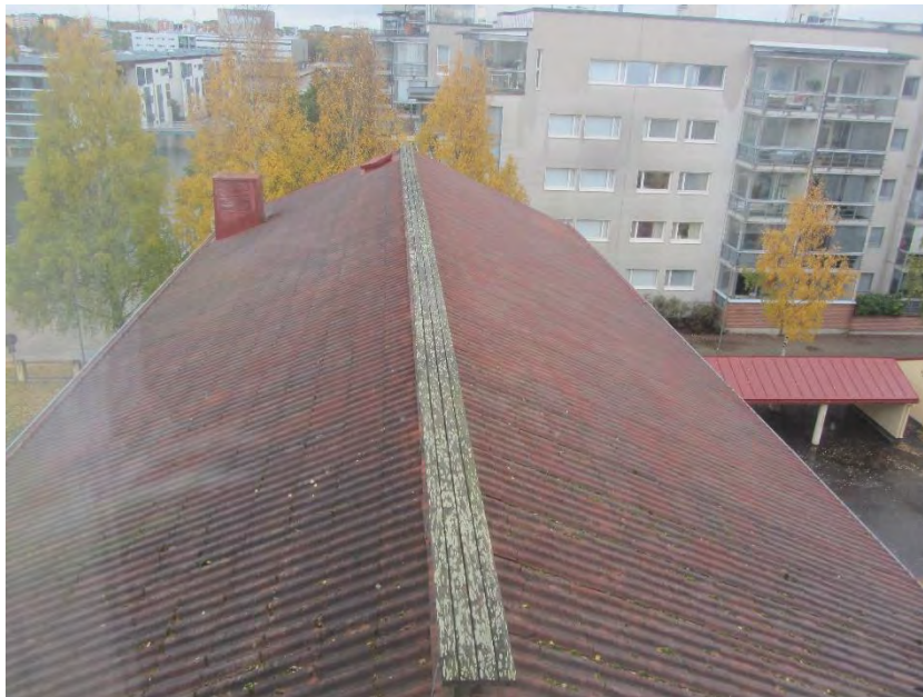
Kuva 7. Juhlasalisiiven asbestia sisältävä aaltominerit-katto.
