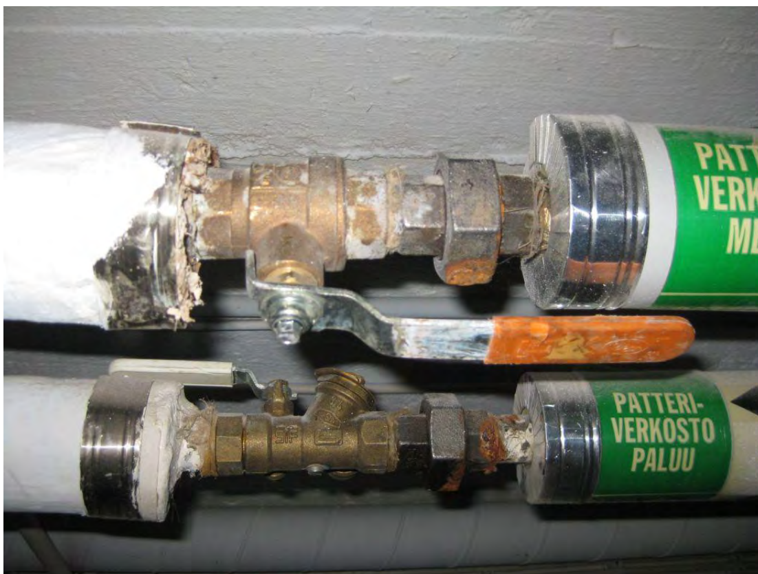
Kuva 5: lämmitysverkoston venttiileiden liittimissä vuotojälkiä. Lämmitysverkoston eristeissä mahdollisesti asbestia (vasen paluuputki)
