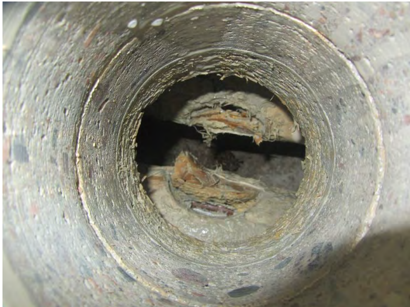
Kuva 3. Kanaalin 2 asbestipahvieristeisiä putkia.
