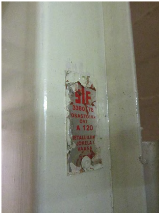
Kuva 9. Palo-ovet sisältävät todennäköisesti asbestia.
