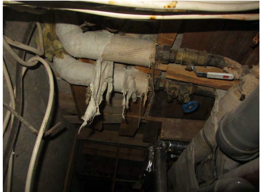
Kuva 4. Kanaalin 4 asbestieristeisiä putkia.
