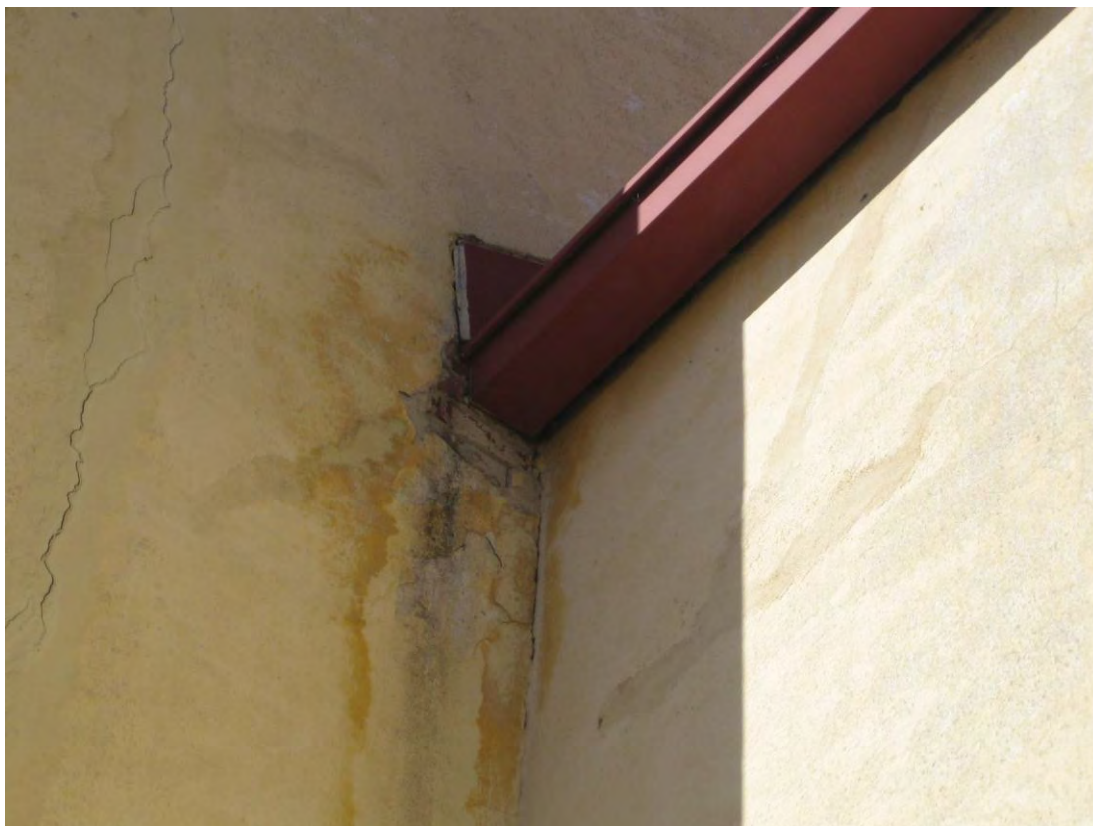
Kuva 14: Julkisivuissa on useita vesikourujen vuodoista aiheutuneita vauriokohtia.
