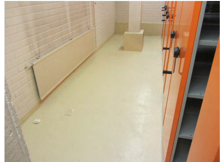
Kuva 12. Kellarin alapohjan maalit sisältävät raskasmetalleja.
