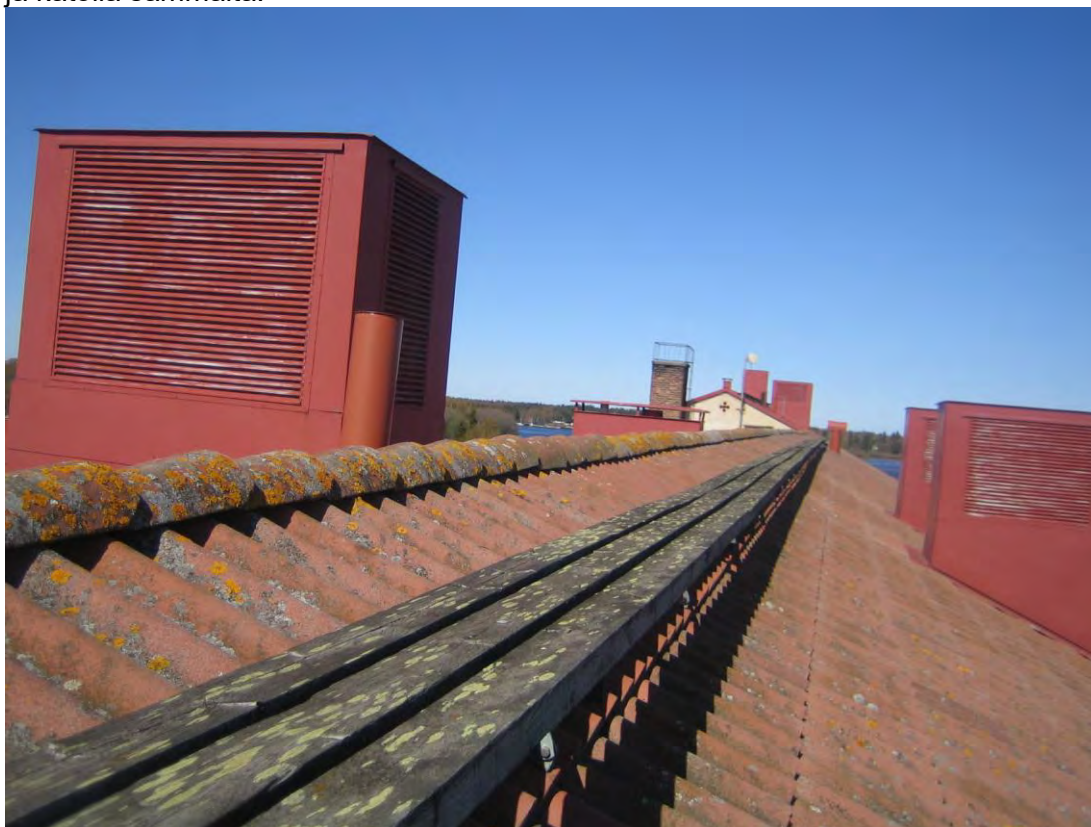
Kuva 18: Yleiskuvaa korkean osan vesikatolta. Katto aikalailla sammaloitunut.
