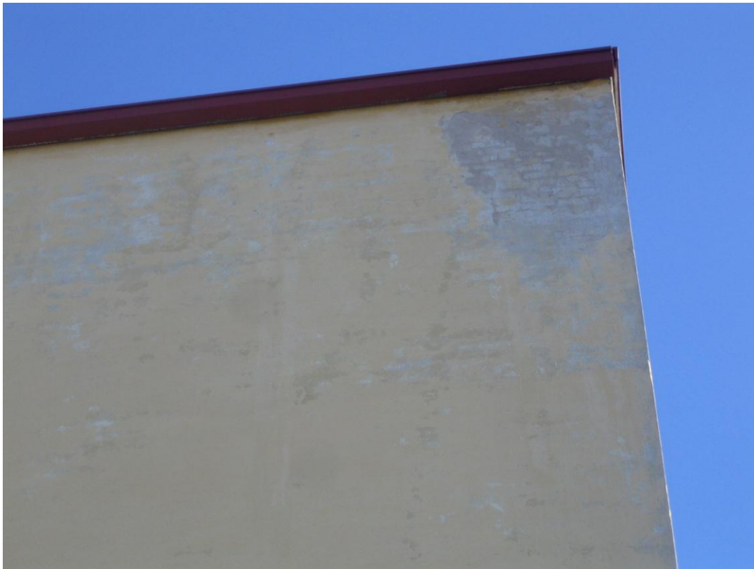
Kuva 10: Rakennuksen Saunarannan puoleisen julkisivun maalipinnat ovat huonossa kunnossa.
