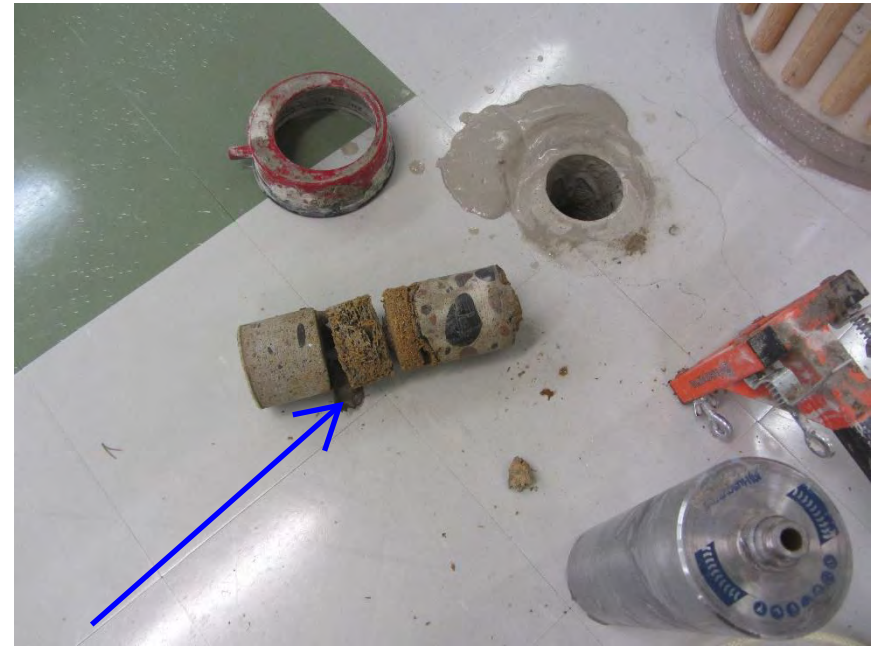
Kuva 10. Ensimmäisen kerroksen alapohjan sekä länsipäädyn välipohjan tervapaperi sisältää PAH-yhdisteitä.
