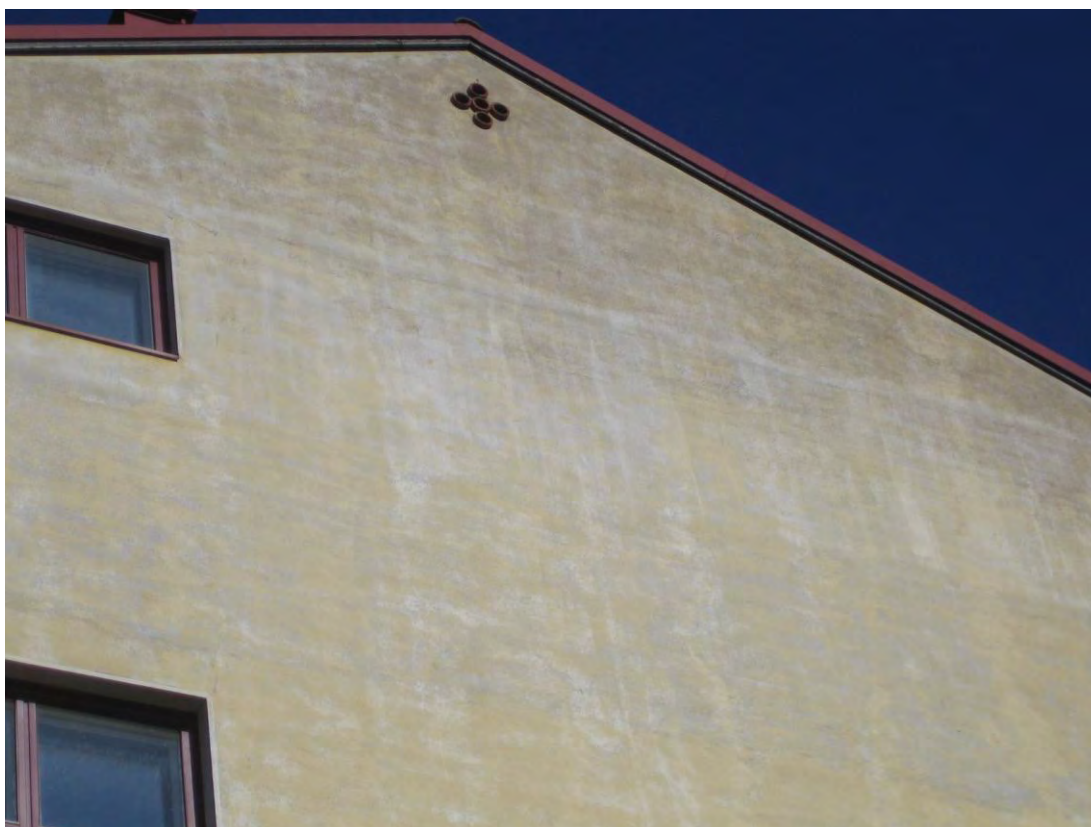
Kuva 11: Rakennuksen Maunonkadun puoleisen päädyn julkisivun maalipinnat ovat huonossa kunnossa.
