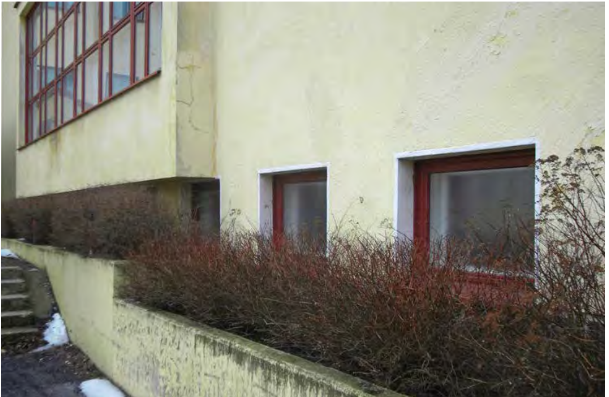
66. Yksityiskohta juhlasaliin julkisivusta. Vuosien 1986-87 peruskorjauksessa pääsisäänkäynnin pihan sokkelien vierustoille toteutettiin betoniset istutusaltaat. Rappaus- ja betonipintojen maalauskäsittelyt ovat heikkokuntoiset. Rappaukset ovat useassa kohtaa halkeilleet. Rappauksia ei peruskorjauksessa uusittu, vaan ne paikkakorjattiin ja ylimaalattiin.
