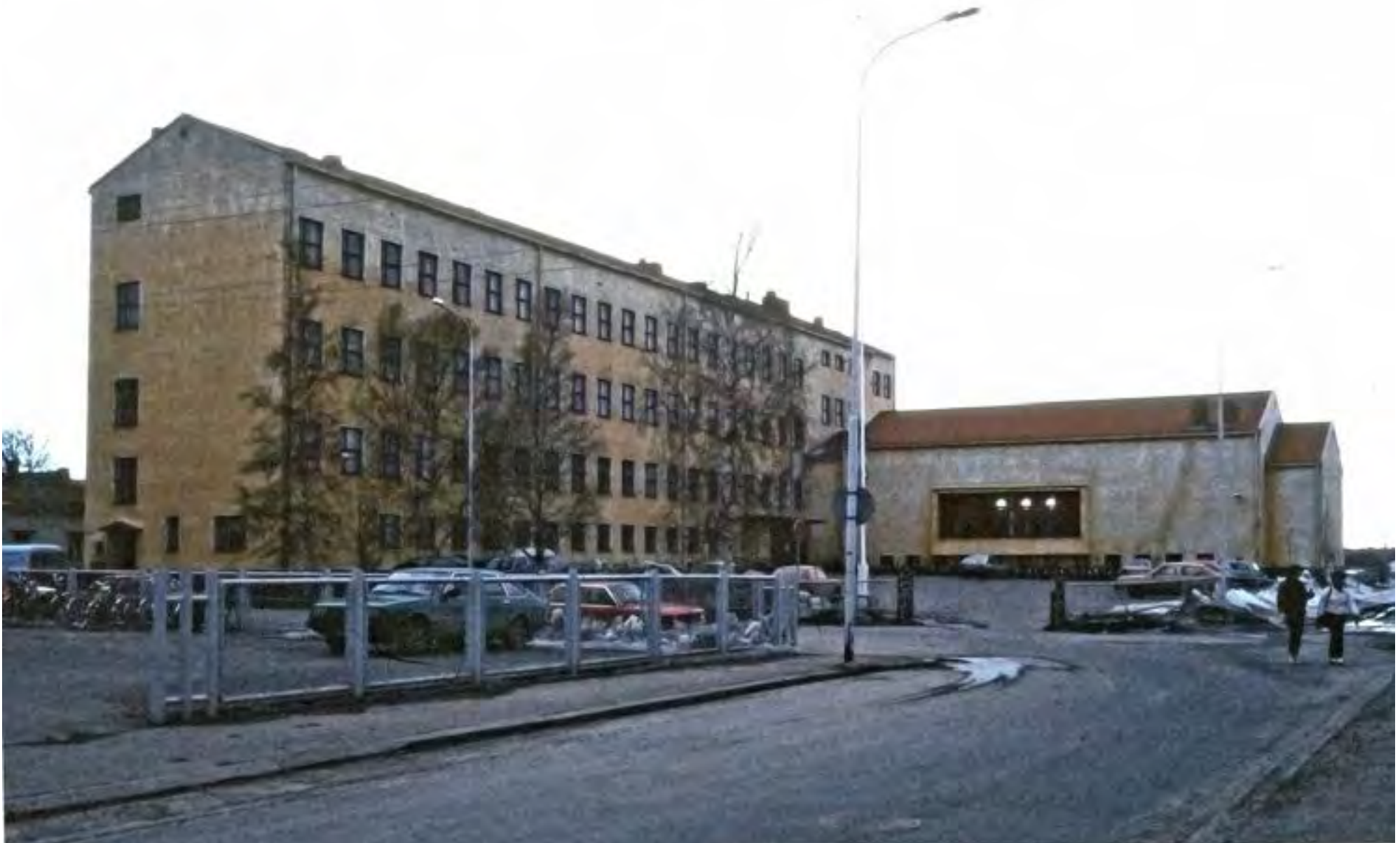
45. Koulurakennus valokuvattuna keväällä 1984. Julkisivut olivat päässeet heikkoon kuntoon. Kalkkipohjainen pintamaali oli peseytynyt pois laajoilta alueilta. Juhlasaliivissä näkyy pitkä pystyhalkeama, joka oli näkyvillä jo tuoreeltaan vuonna 1957 (kuva 37).
