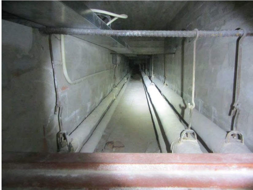
Kuva 1. Kanaalin 3 asbestia sisältävää putkieristemassaa.
