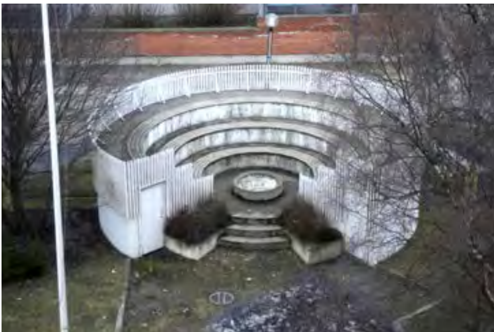
93. Pihan puu- ja betonirakenteet vaativat huolto- ja kunnostustöitä. Kuvassa pihavarasto/oleskelupaikka.
