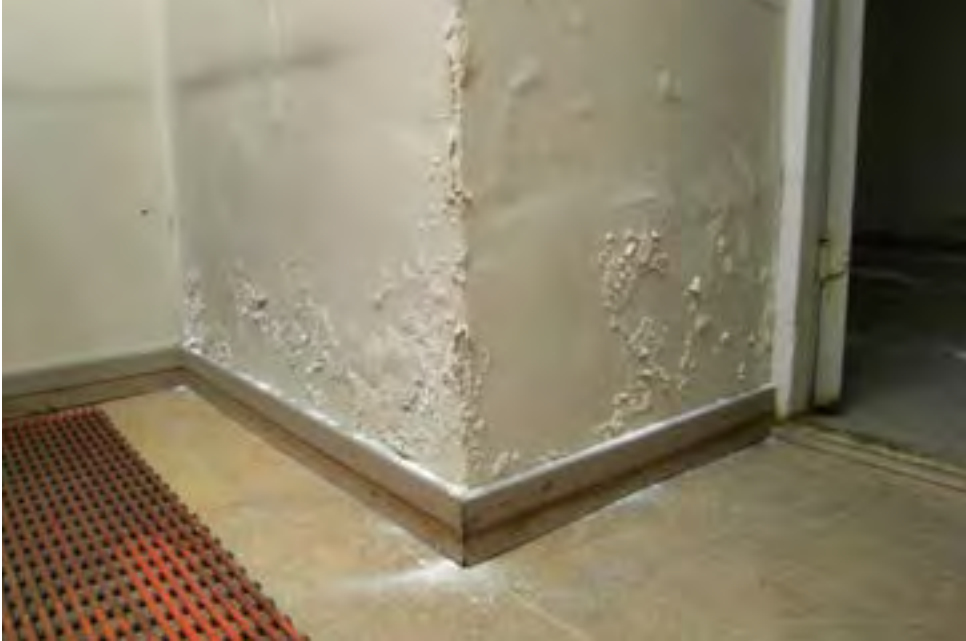
42. Keittiön ja talonmiehen asunnon alapuolisissa kellaritiloissa on merkittävä kosteusvaurio.
