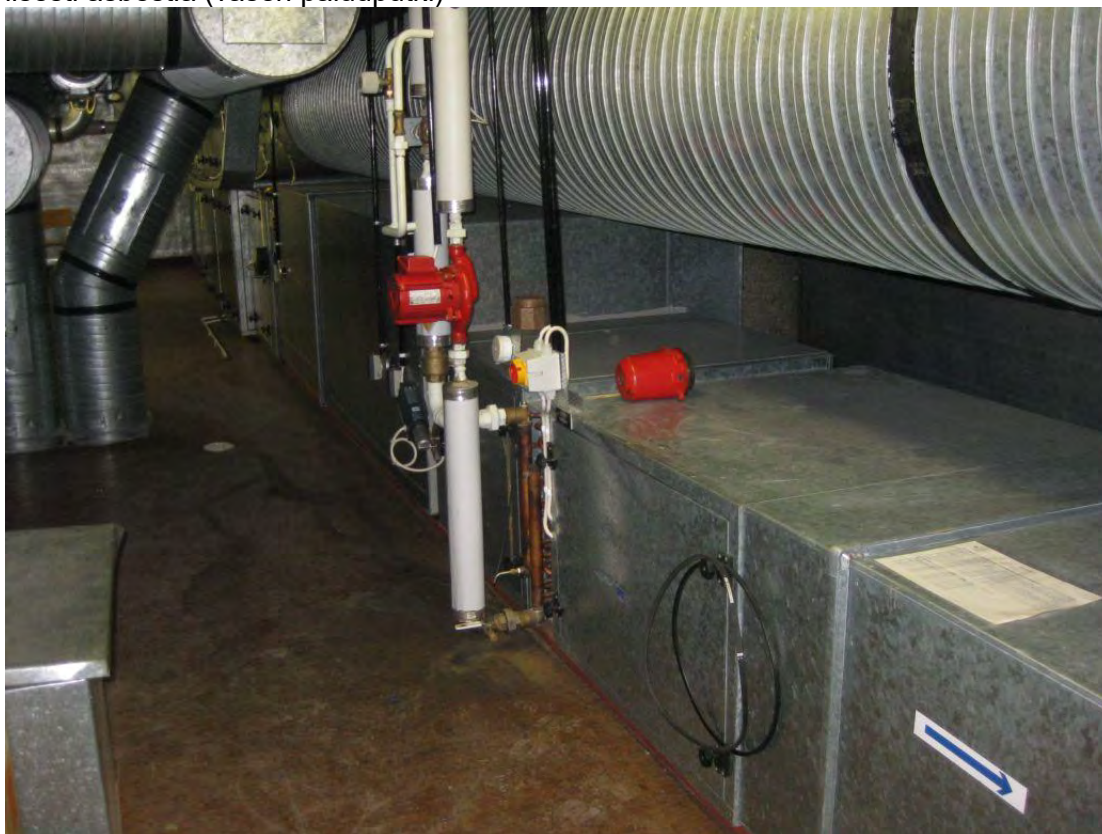
kuva 6: ilmanvaihtokoneet ovat vanhoja ja pienehköjä tarpeeseen nähden.
