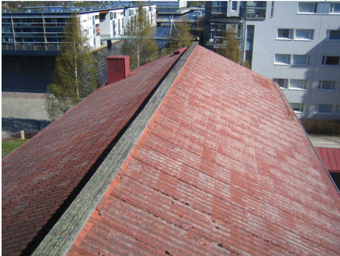
Kuva 17: Yleiskuvaa liikuntasaliosan vesikatolta. Varttikatteen maalipinnat huonossa kunnossa ja katolla sammalta.
