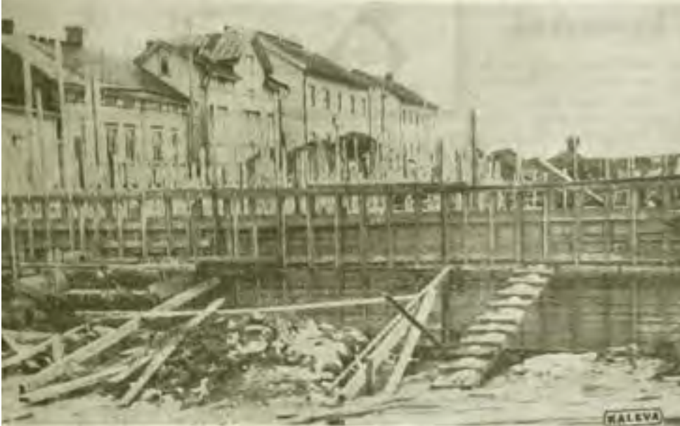
26. Sanomalehti Kalevassa 19.11.1955 ollut kuva koulurakennuksen työmaalta. Kuvassa perustustöiden muottirakenteita. Taustalla Kuusiluodon asuinrakennuksia.
