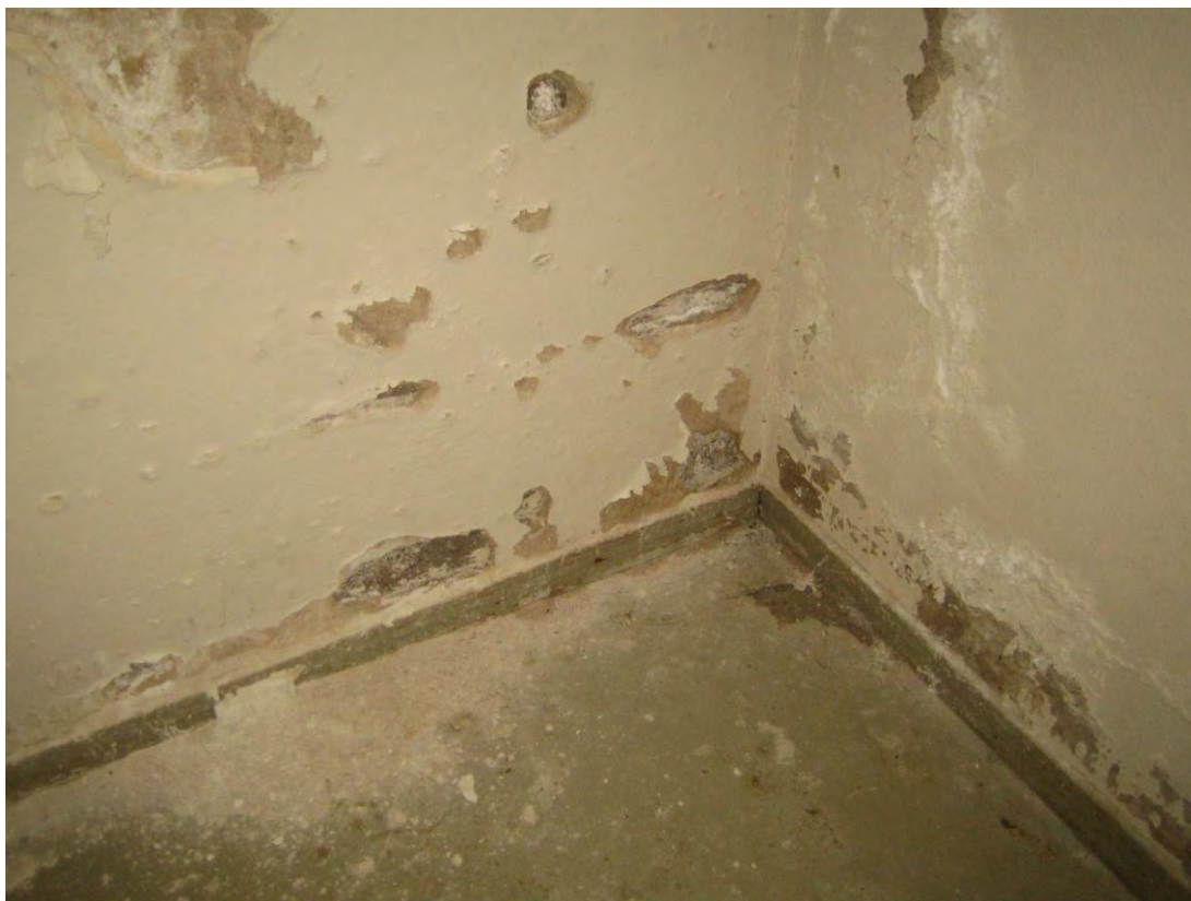
Kuva 7: Maunonkadun päässä olevan talouskellarin seinissä nähtävissä mittavat kosteusvauriot.
