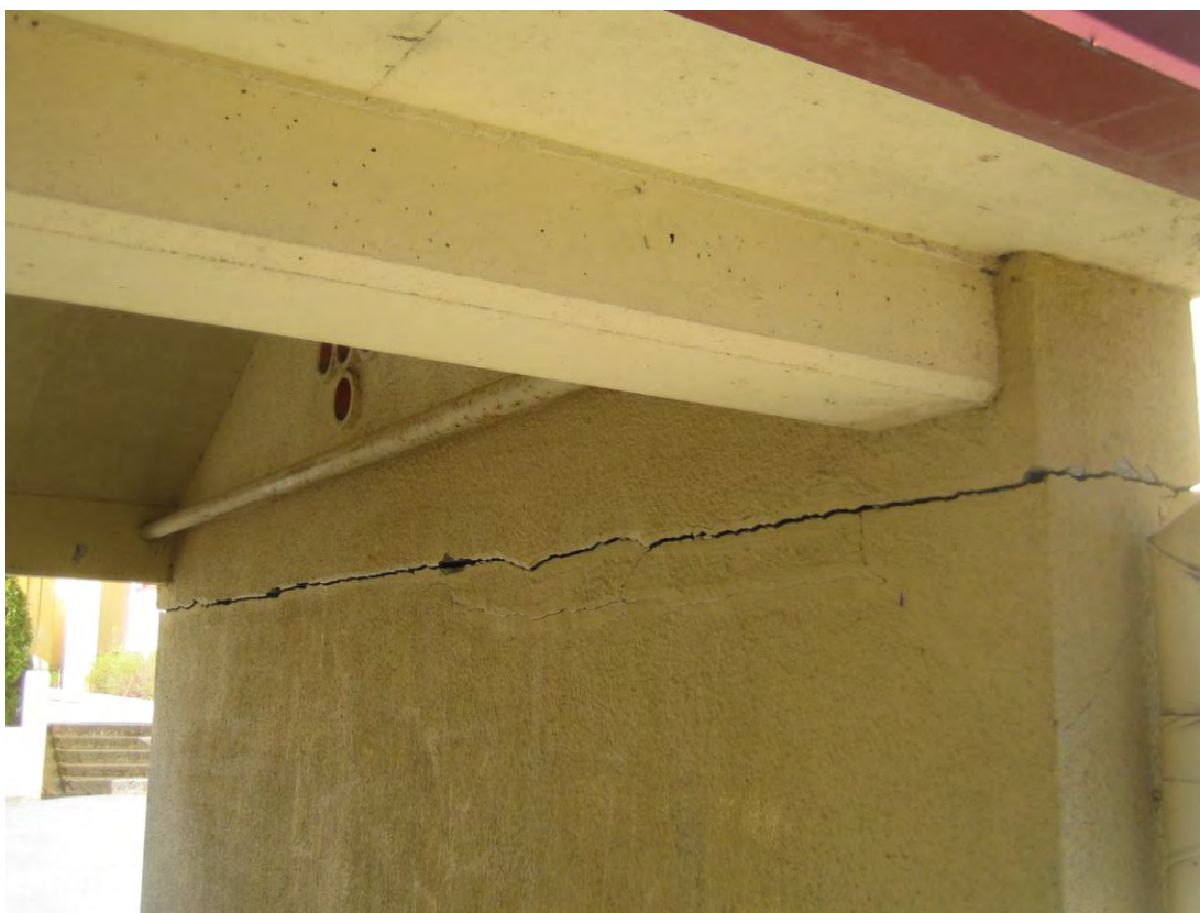
Kuva 5: Polkupyöräkatoksen kantavassa päätyseinässä suurehko halkeama.
