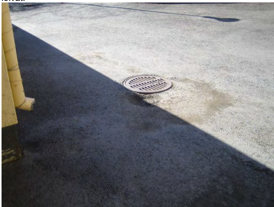
Kuva 2: Pyöräkatosten edessä oleva sadevesikaivo on liian korkealla ja asfaltissa on reikä.
