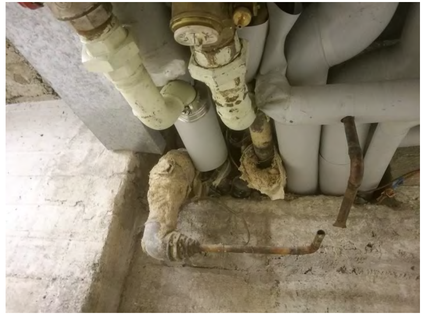
Kuva 6. Lämmönjakuhuoneen tulppaamattomia putkien asbestimassaeristeitä.
