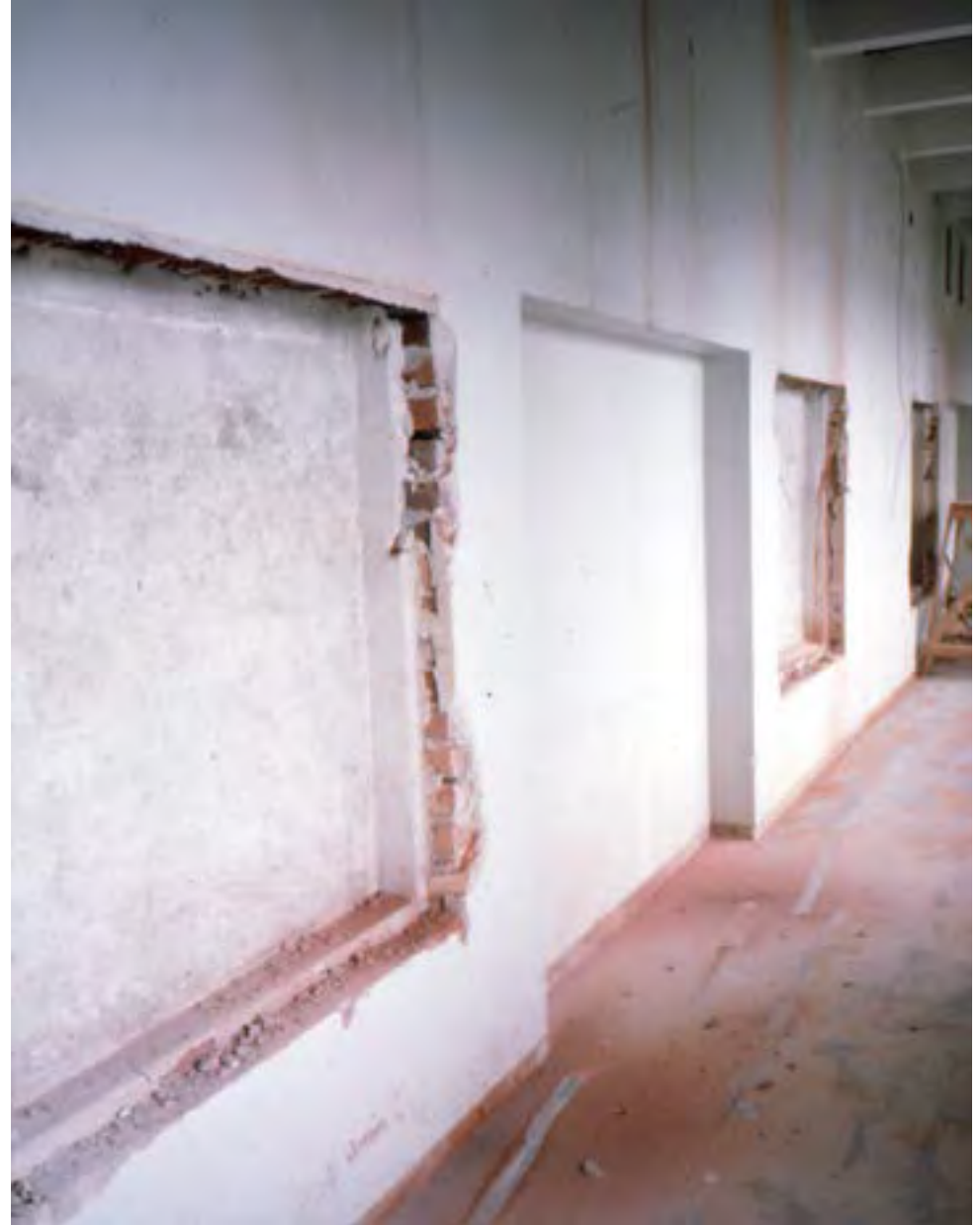
54. Koulusiiven pitkien käytävöiden seinäpinnoissa oli alkujaan syvennyksiä, jotka toimivat vitriini- ja kalustesyvennyksinä. Syvennyksistä osa on tallella, niiden ympärille on toteutettu lasi vitriiniejä ja opiskelijoiden henkilökohtaisia säilytyskappeja.
