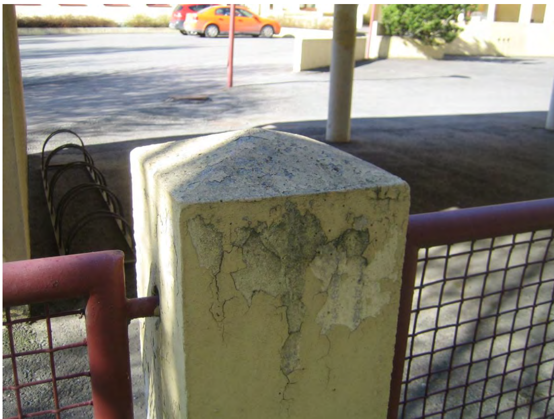
Kuva 4: Tontin ympärillä kiertävän aidan betoniosien maalipinnat ovat monin paikoin huonossa kunnossa.
