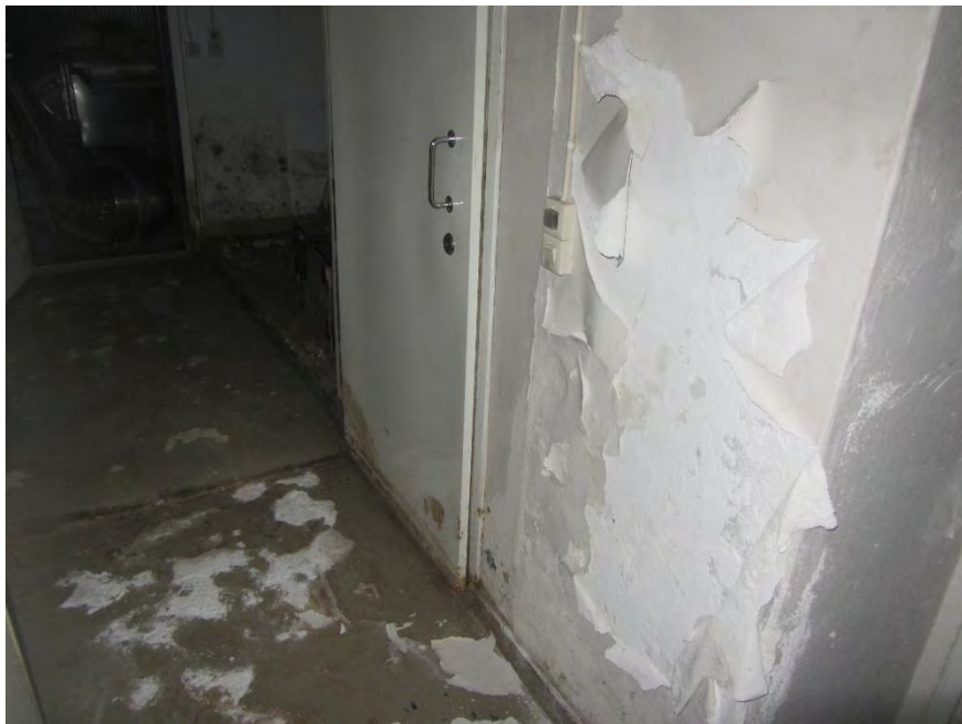
Kuva 13. Itäpäädyn kellarin lattian ja seinien maalit sisältävät raskasmetalleja.
