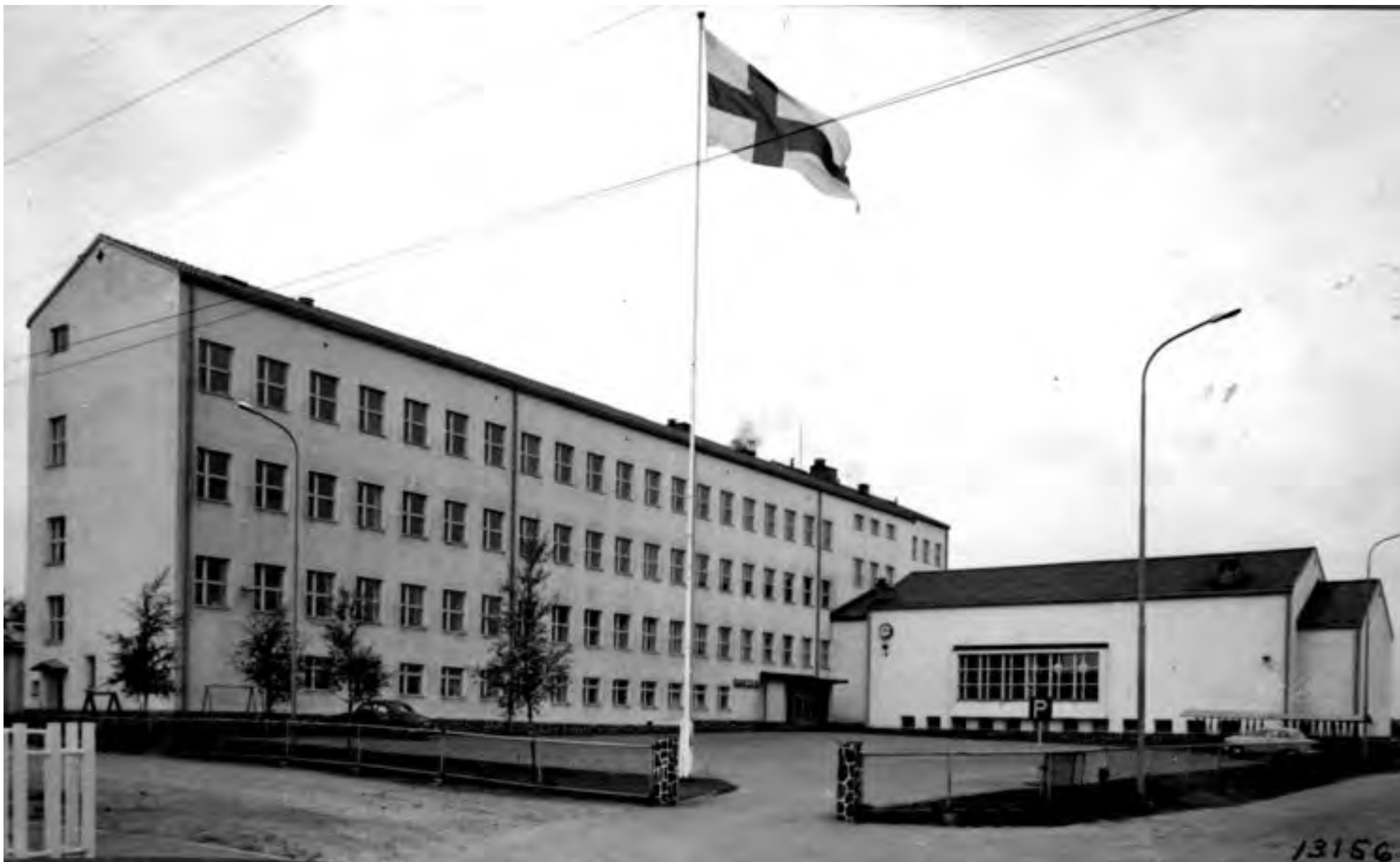
37. Koulurakennuksen pihalle toteutettiin asfaltointi kesällä 1957. Myös pääsisäänkäynnin viereen seinälle on ilmestynyt teksti Kauppaoppilaitos . Juhlasaliin ulkoseinässä on jo nähtävissä tuore pystyhalkeama, joka on nykyäänkin näkyvissä. Kuva on Kalevan arkistosta.
