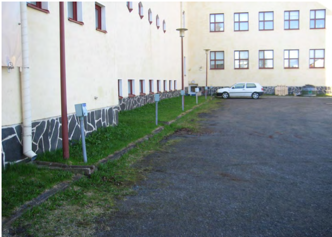
Kuva 1: Pihavalaistusta ja autolämmitystolppia.
