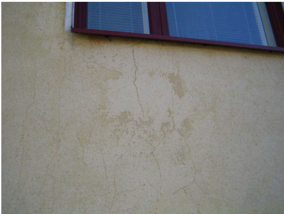
Kuva 13: Saunarannan puoleisessa julkisivussa rappaus osin alustasta irti.
