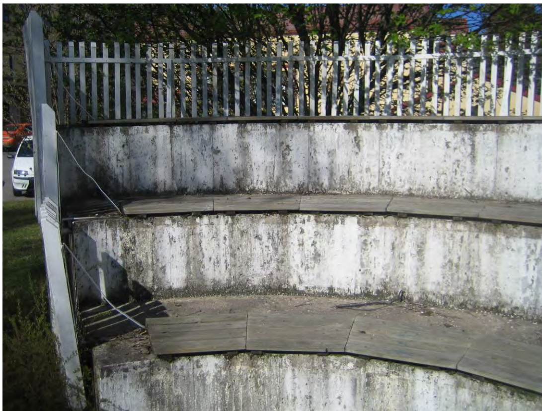
Kuva 6: Ulkovälinevaraston sisäpihan puolen maalipinnat ovat todella huonossa kunnossa.
