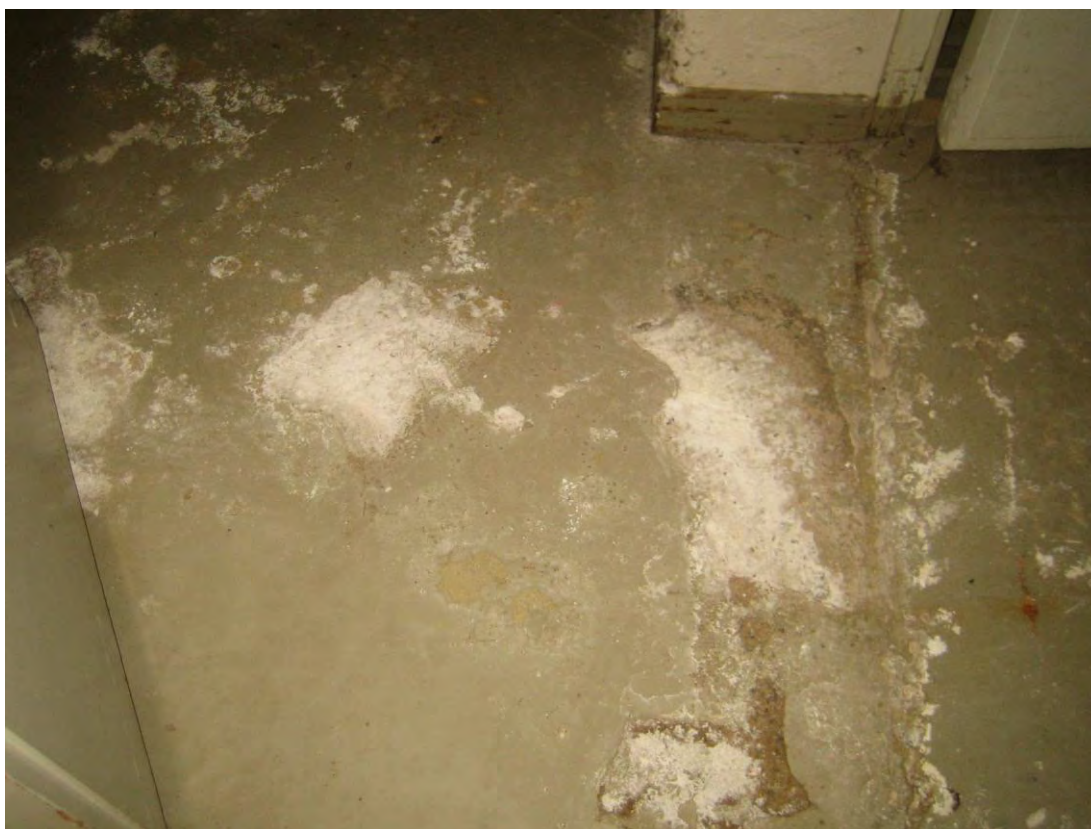
Kuva 8: Maunonkadun päässä olevan talouskellarin alapohjissa mittavat kosteusvauriot.
