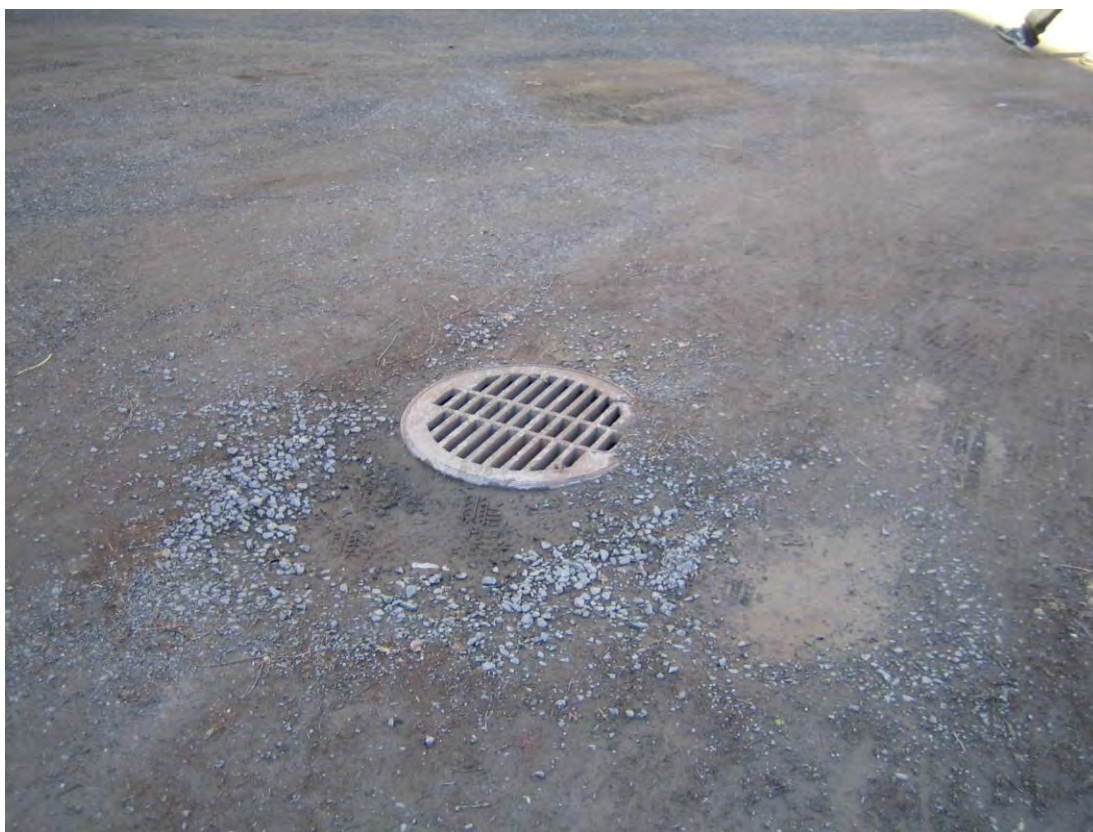
Kuva 3: Takapihan kivituhka-alueella sadevesikaivot osin liian korkealla.
