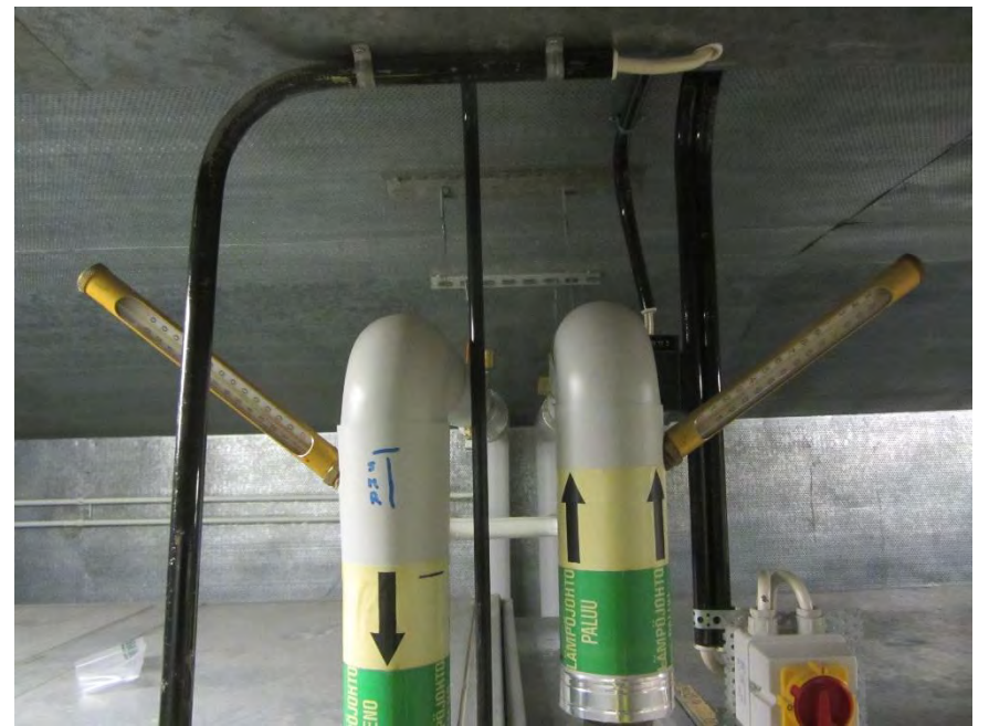
Kuva 14. Teknisissä tiloissa elohopeaa sisältäviä lämpömittareita.
