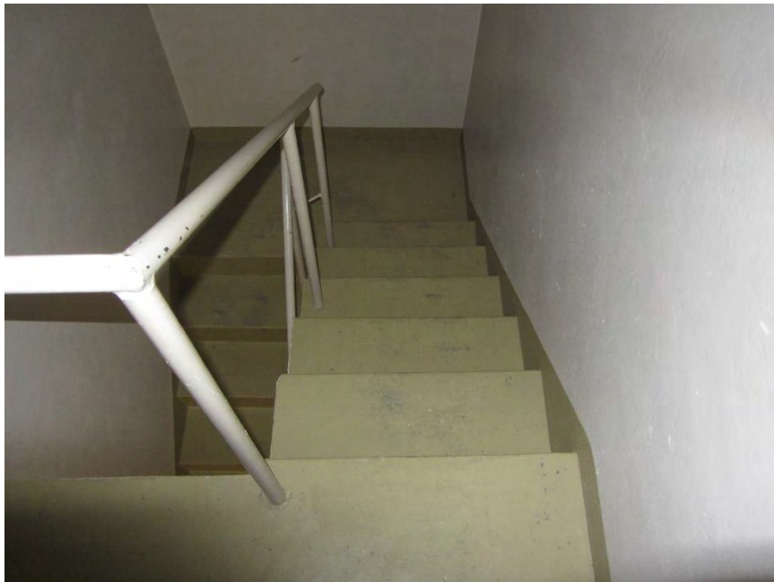
Kuva 11. Juhlasalin valo-ohjaushuoneen portaikon maali sisältää lyijyä.
