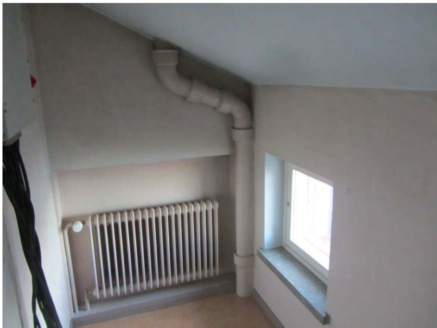
Kuva 15. Valurautaputkien liitokset sisältävät todennäköisesti lyijyä.
