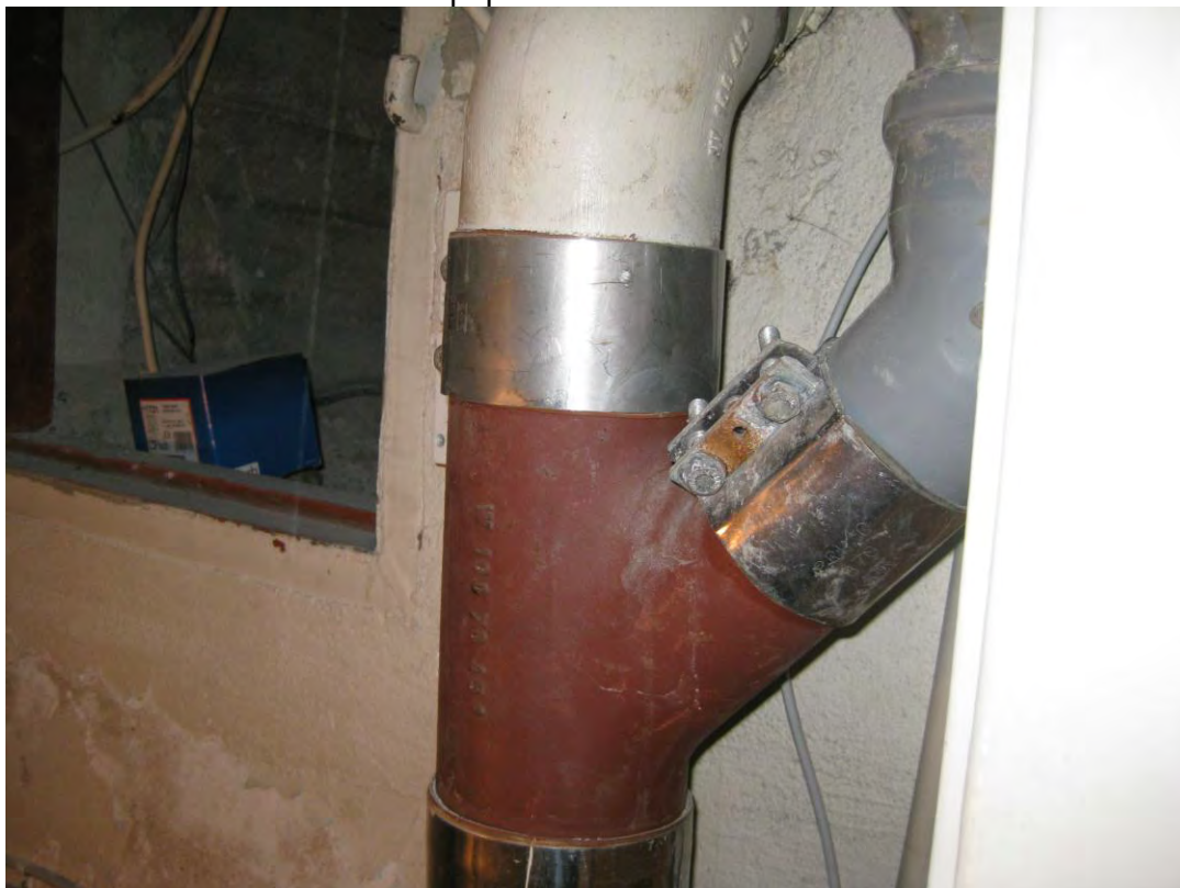
Kuva 2: viemäriverkostossa on alkuperäistä valurautaviemäriä käytössä (valkoinen putki punaisen putken yläpuolella).
