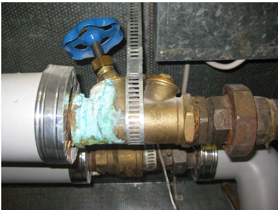
Kuva 3: lämmitys- ja käyttövesiverkostoissa on käytössä vanhoja istukkaventtiileitä.
