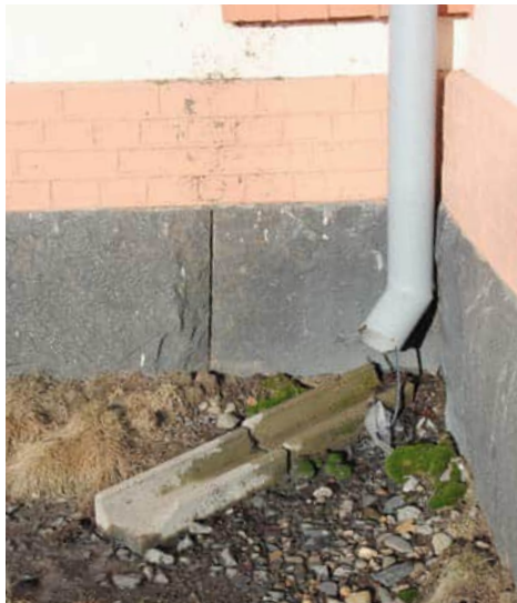
99. Koskitien puolella sadevesi johdetaan katolta maaperään.
