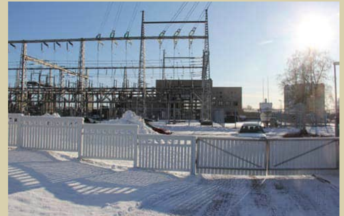
77. Koulun edessä on Merikosken voimalaitoksen kytkinkenttä.
