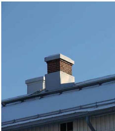
101. Vesikatto tuulettuu sivuräystäiltä. Räystäällä on sadevesikourut ja lumiesteet.
