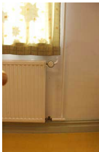
156. Ensimmäisen kerroksen radiaattori
