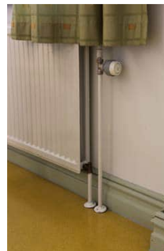
157. Toisen kerroksen radiaattori.
