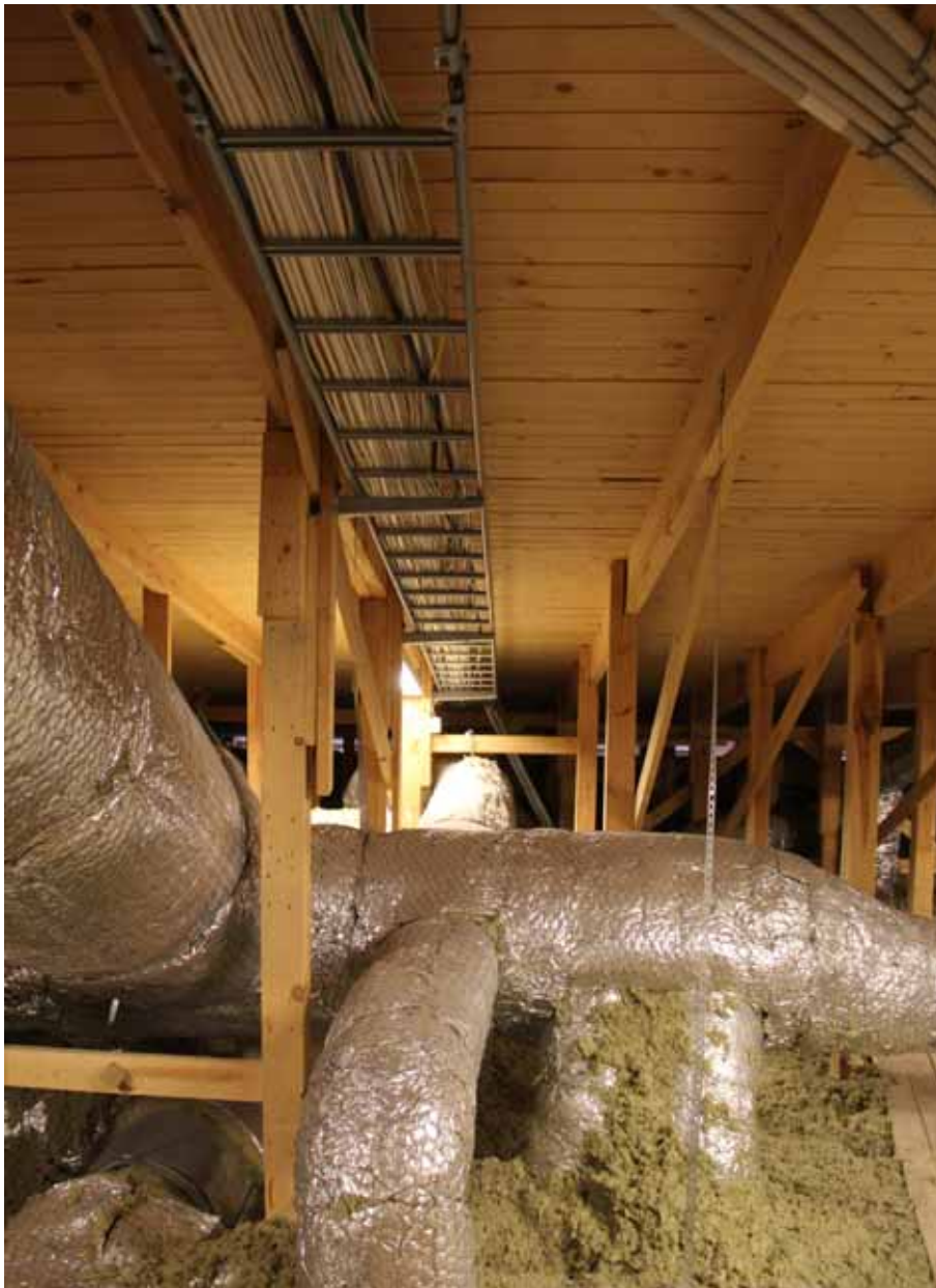
100. Vuonna 2004 vanhan tasakaton päälle rakennettu vesikatto toteutettiin kattotuoleilla. Alkuperäisen katon bitumipinta kuorittiin, desinfioitiin ja yläpohja lisäeristettiin. Tuuletustilaa hyödynnettiin uusien kanavien ja johdotusten sijoittamisessa.
