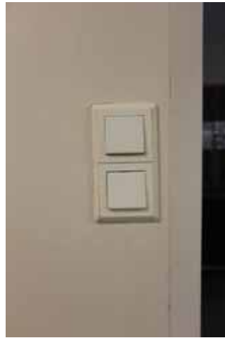
212. Sähkökalusteet ovat pääosin 2000-luvun malleja.
