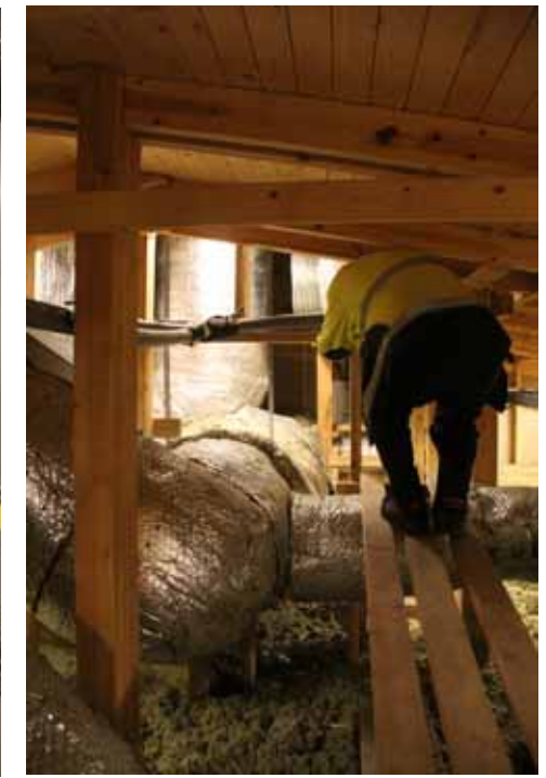
208. Puiset kulkusillat johtavat vesikaton tarkastusluukuille. Reitti on paikoin vaikeakulkuinen.
