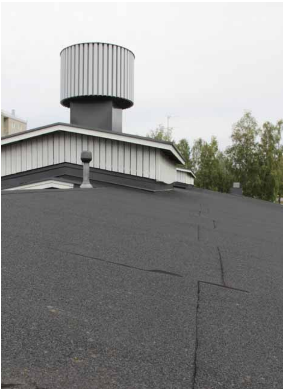
94. Uudesta vesikatosta pyrittiin tekemään mahdollisimman matala. Ilmanvaihtolaitteistolle tehtiin harjan yläpuolelle kohoava huonetila. Kuvassa näkyvää pyöreää päätelaitetta ei esiinny muutospiirustuksissa.
