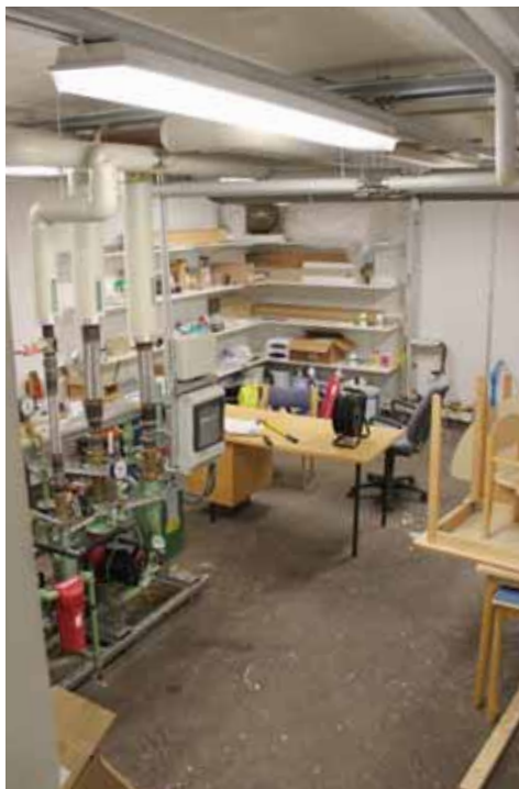
204. Öljylämmitykseen liittyneet laitteet on purettu pois. Tilalla on kaukolämpö ja kiinteistöhoitajan toimisto.
