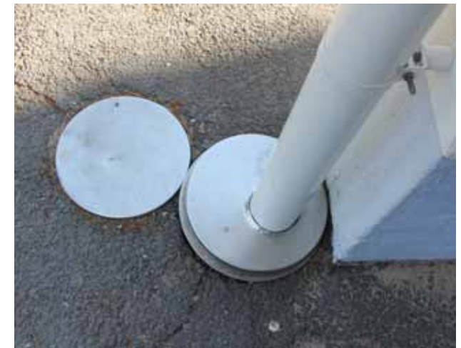
97. Vesi johdetaan suoraan maanalaiseen hulevesijärjestelmään. Kuvassa on myös salaojajärjestelmän tarkastuskaivo.
