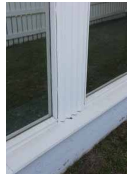
111. Pilarin kohdalla on poimulevy.
