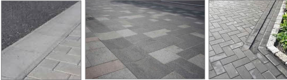
Kuva 14. Hulevesiä kuljettavia kouruja ja kourulaattoja. Kuvat vasemmalta: Rudus, Rudus, Turun kiviurakointi.
