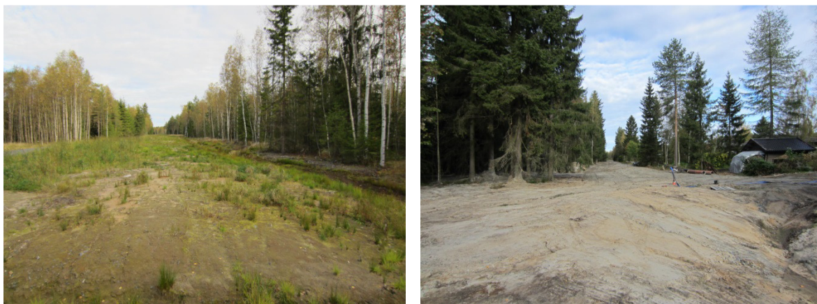
Kuvat 10 ja 11. Jäteveden runkoviemärin aukkoja maisemassa.
