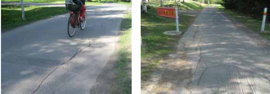
Kuva 12. Kevyen liikenteen väylien päällystevaurioita
