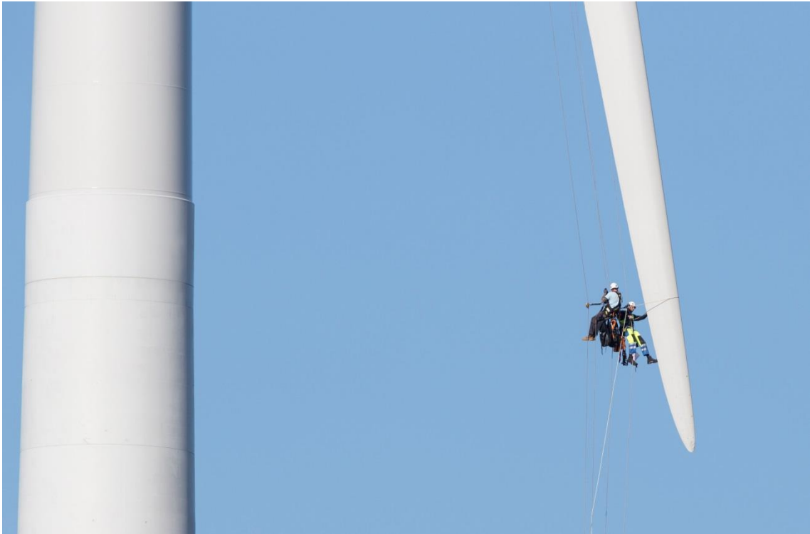
Kuva 25. Tuulivoimalan huoltotoimenpiteitä. (Kuva: FCG).
