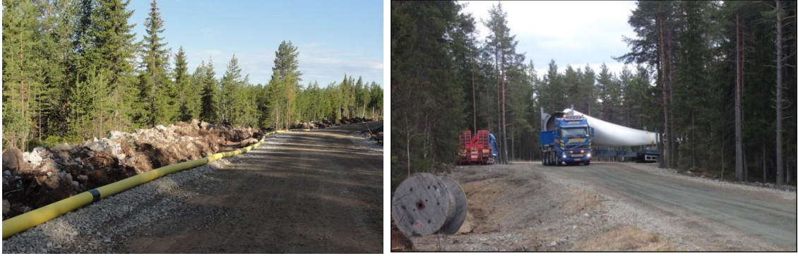
Kuva 18. (Vasemmalla) Esimerkki tuulivoimapuiston rakennus- ja huoltotiestä rakentamisaikana. Teitä käytetään muun muassa betonin, soran ja voimaloiden komponenttien kuljetuksiin sekä tuulivoimapuiston käyttövaiheessa huoltoajoihin. Maakaapeli sijoitetaan ojakaivantoon tien reuna-alueelle. (Oikealla) Tuulivoimalan osia kuljetetaan erikoiskuljetuksina. (Kuvat: FCG).
