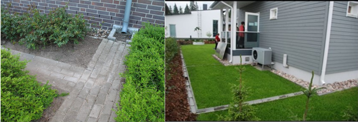
Kuva 20. Esimerkki kattovesien johtamisesta. Esimerkissä hulevedet johdetaan syksytorvista betonista kourua myöden viherkaistaleelle, joka sijaitsee riittävän etäällä rakennuksesta. Vasen kuva on Hannoverista ja oikea kuva Tampereen Vuoreksesta. 12
