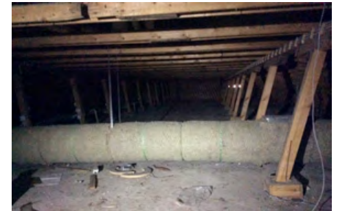
Eristetty ilmanvaihtokanava kylmällä ullakolla.
