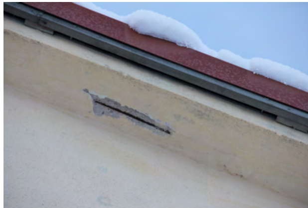
Teräsbetonista valettu räystääs on umpinainen. Lohkeamasta näkyy raudoitusta.
