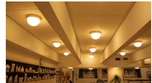
Kupuvalaisimet kattopalkkien väleissä.
