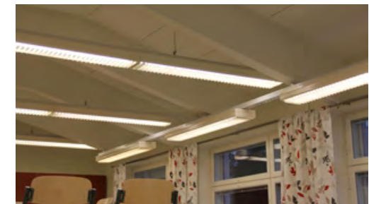
Jonovalaisimet kattopalkkien tasossa.
