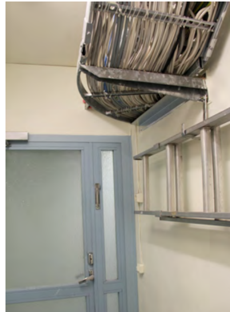
Kaapelihylly kellarin aputilan alakatossa.
