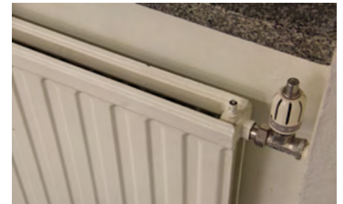
1990-luvulla uusittu lämpöpatteri ja termostaatti.
