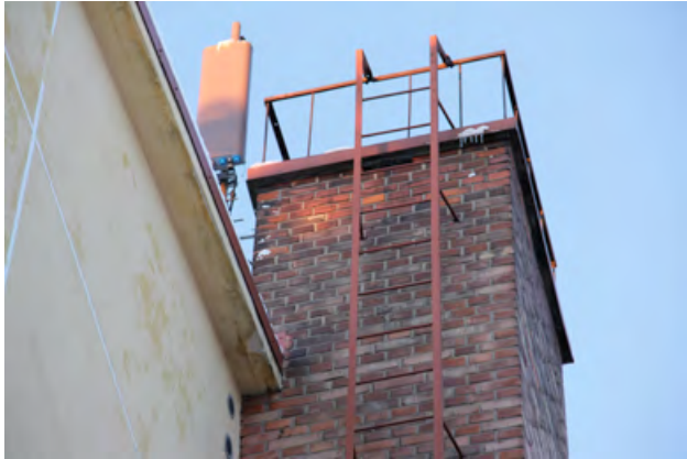
Tiilistä muurattu lämpökeskuksen piippu on käyttämätön ja kerää kosteutta.
