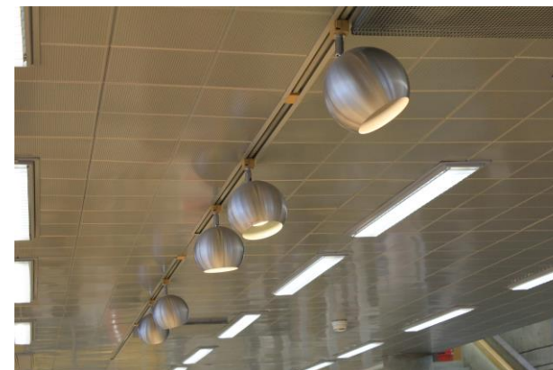
Alumiinikasettikatto, johon valaisimet on upotettu ja kiskot sijoitettu kasettien saumakohtiin.
