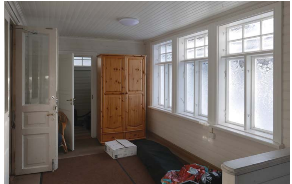
114. Johtajan asunnon kuisti. Kuistin ikkunat ja pariovet ovat vanhat.
