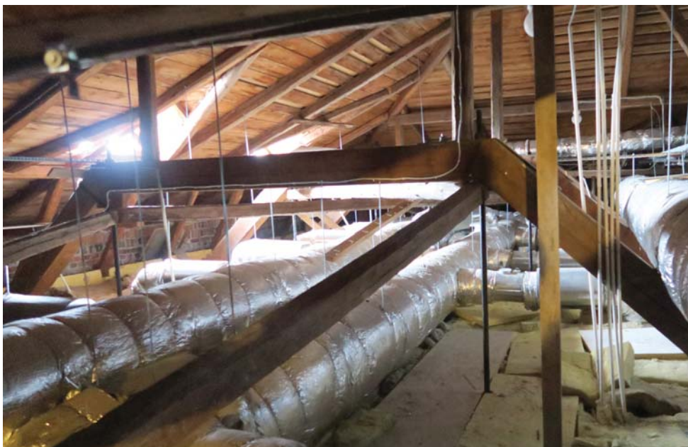
81. Ullakolla on näkyvissä salinkaton alkupeärinen ansarakenne. Myös vanhat puuristikot ovat näkyvissä IV-putkien lomassa.
