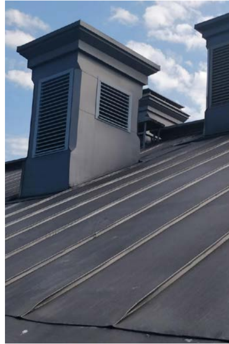
Ilmanvaihtokojeiden muoto jäljittelee vanhojen savupiippujen muotoja. KUVA: Kattotutka Oy
