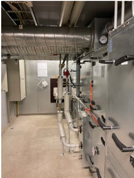
Ullakolla on vuonna 1989 tehty ilmanvaihtokonehuone.
