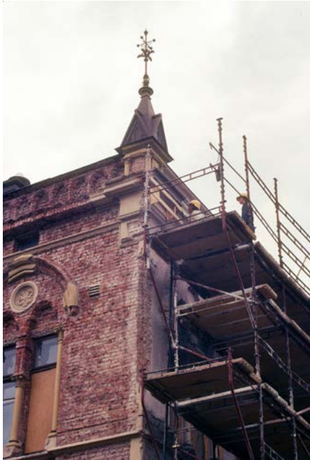
Julkisivurappaus ja julkisivun koristeosat on poistettu Torikadun ja Hallituskadun kulmalta. KUVA: Oulun Tilapalveluiden arkisto
