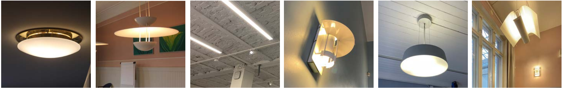
Kulttuurikeskus Valveen rakennuksessa käytössä olevia valaisimia.
