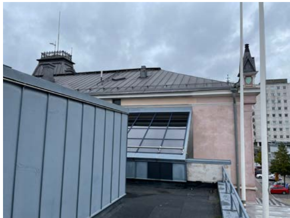
Uudisosassa on bitumihuovalla päällystetty tasakatto. Vasemmalla on Valvesalin korkea osa ja sen takana sisäänkäynnin valokate.
