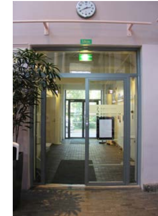
Eteisen teräsrunkoinen ovi
