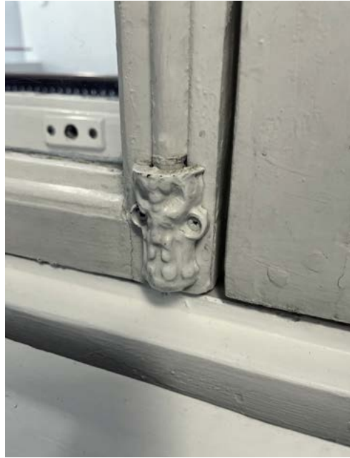
Käytävän ikkunoiden sisäpuutteet ovat alkuperäiset ja niiden espanjoletit on säilytetty. Ulkopuutteeseen on lisätty palonkestävä lasi.
