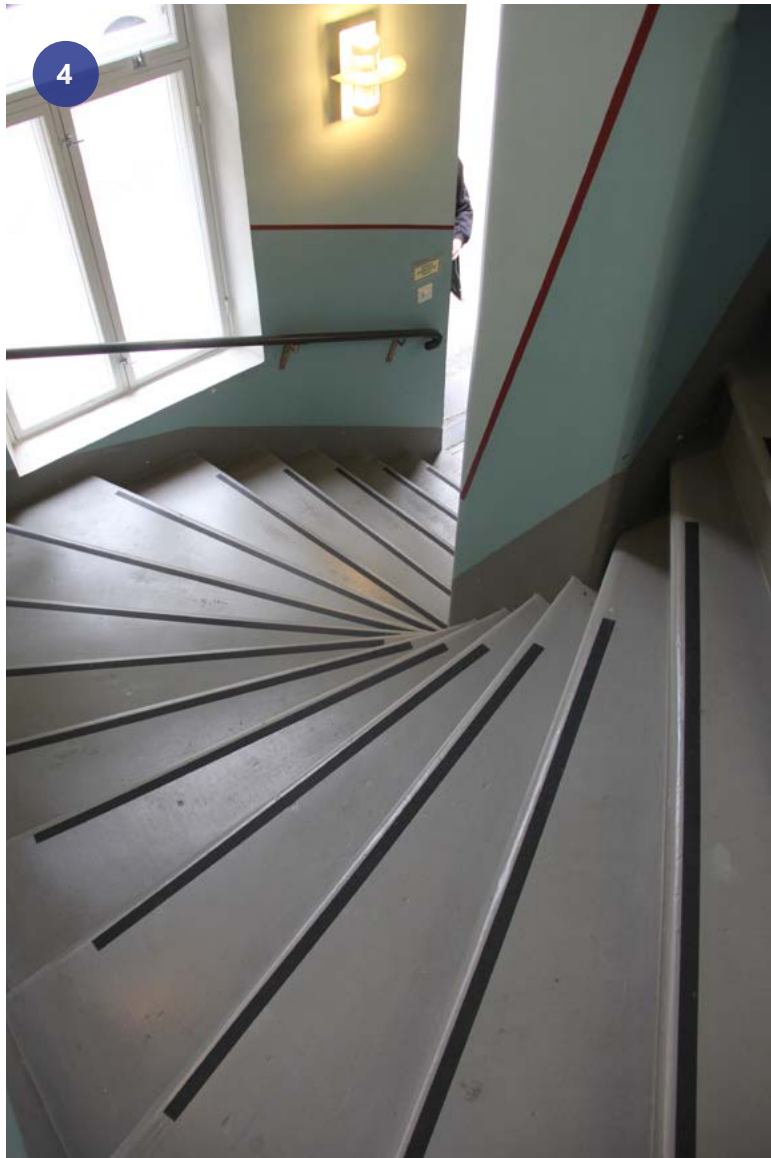
Porras kiertyy ilman lepotasoa ensimmäiseen kerrokseen.
