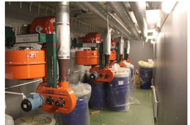
Väestönsuojan laitteistoon kuuluu varavoimalla toimivat puhdistimet ja ilmanvaihtokoneet.
