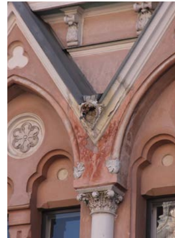
Vedenheittäjien koristeet ovat kärsineet vaurioita.
