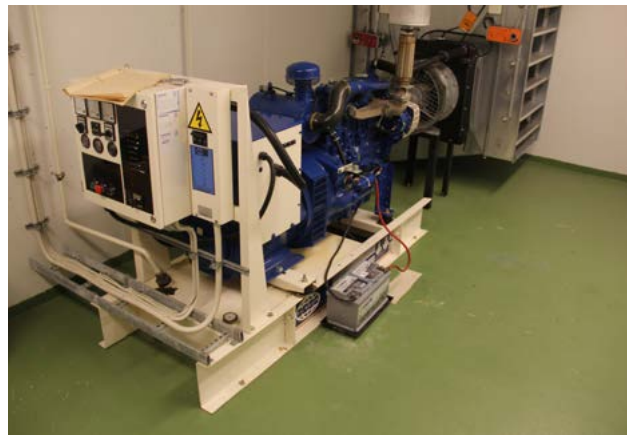
Varajohtokeskukseen kuuluu dieselkäyttöinen varavoimakone sekä erilliseen säiliöhuoneeseen varastoitu polttoainesäiliö.
