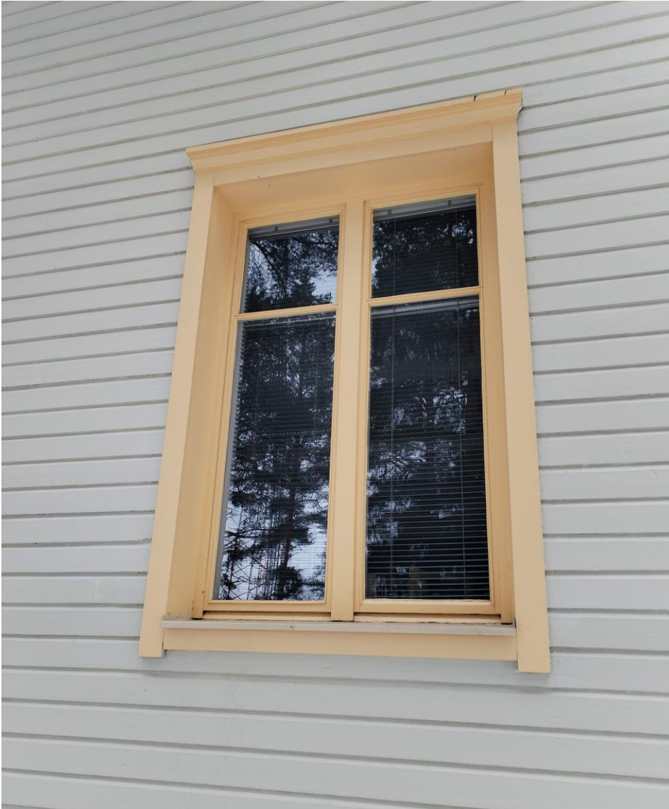
Puukoulun ikkunat on uusittu, todennäköisesti 1960-luvun muutosten yhteydessä. Nykyiset ikkunat ovat sisäänaukeavat. Ikkunoiden keskellä oleva pystypuite on leveämpi kuin alun perin.
