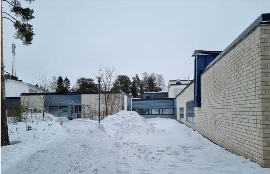
Koulurakennusta kuvattuna luoteesta. Laajennusosan ikkunat ovat korkeammalla alkuperäiseen osaan verrattuna. Kuvassa vasemmalla näkyy ikkunoiden molemmin puolin alkuperäisiä pysty-laudoitettuja yksityiskohtia.
