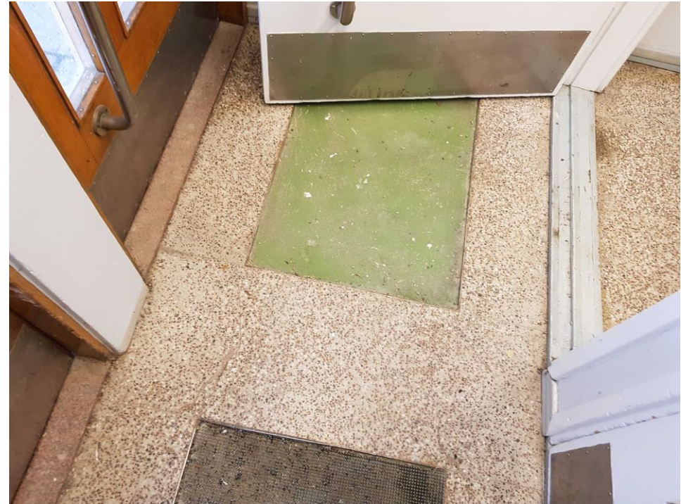
Pääsisäänkäynnin tuulikaapin lattia on mosaiikkibetonia. Lattiaan on tehty listoilla rajatut upotetut mattosyvennykset. Ulko-ovien kynnykset ovat graniittia, väliovien kynnykset ovat metallilistoilla vahvistetut puukynnykset.
