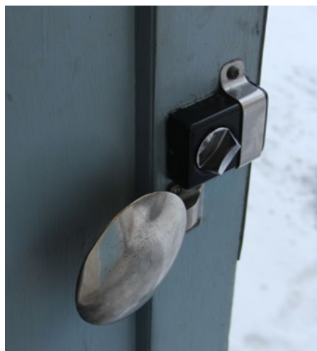
69. Ulko-oven sisäpuolinen vedin on messinkiä. Lukkolaite on uusittu.
