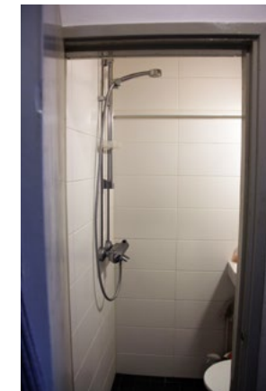
57. WC on varustettu suihkulla ja lattiakaivolla.
