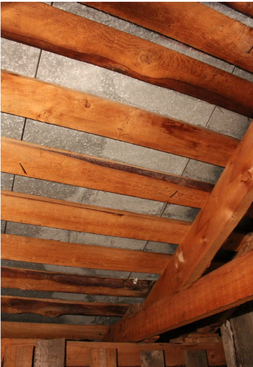
82. Vesikattorakennetta ullakon suunnasta katsottuna. Galvanoitu rivipelti on ladottu harvalaudotuksen päälle ilman aluskatetta.
