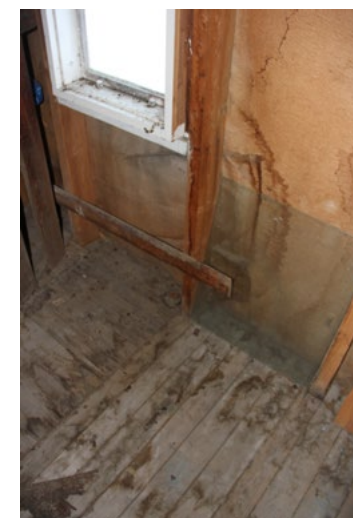
85. Päätyseinä on vuorattu pähvillä. Rakenne on kastunut.
