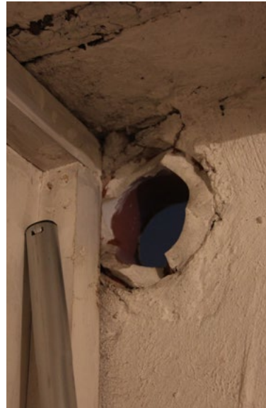
105. Saviputki toimii ilmanvaihtokanavana.
