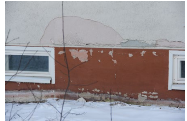
51. Julkisivurappaus on tehty metalliverkon päälle. Vaurio-kohtissa näkyy vanhaa rappausta ja paikkauksia.
