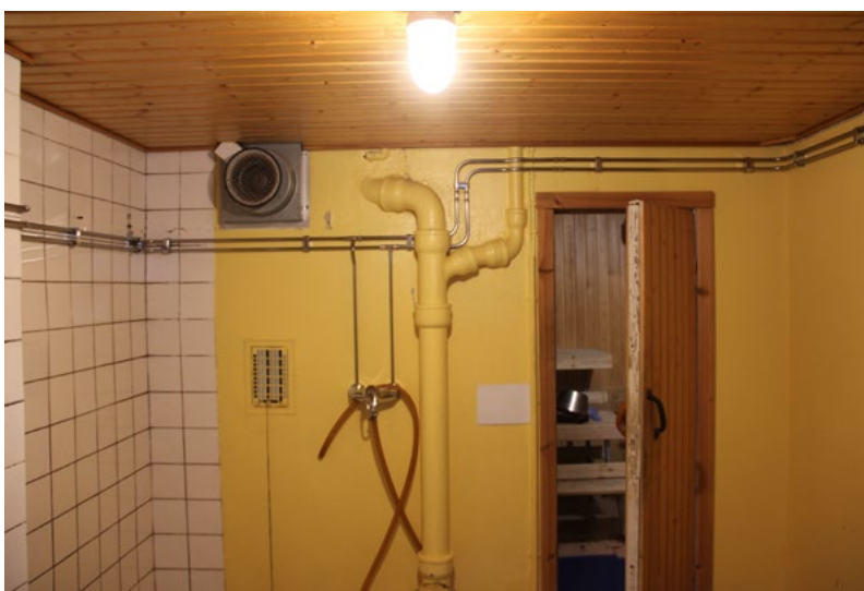
114. Yläpuolelta laskeva viemäri on jätetty näkyviin saunan pesuhuoneessa.
