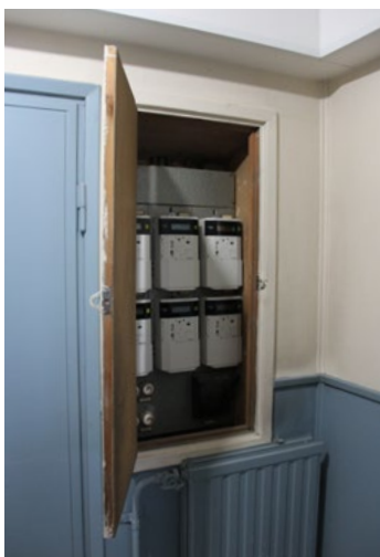
70. Porrashuoneessa on huoneistojen sähkömittarit.
