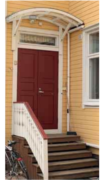
53. Ulko-ovet on uusittu alkuperäisen mukaisina puuovina. (Kuva: Riitta Kosonen, Arkkitehtitoimisto Jorma Teppo Oy, 5/2021.)
