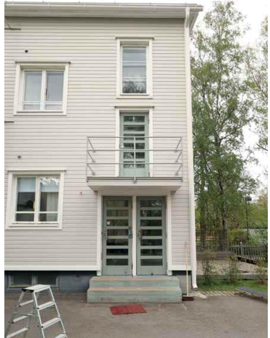
117. Toukokuussa 2021 rakennuksessa suoritettiin huoltomaalaus. Kuvassa tuore maalipinta. Ovet, ikkunat ja parvekkeiteet ovat alkuperäiset tai alkuperäisen suunnitelman mukaiset. (Kuva: Riitta Kosonen, Arkkitehtitoimisto Jorma Teppo Oy, 5/2021.)
