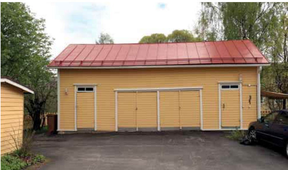
43. Navetta muutettiin 1960-luvun lopulla kahdeksi autotalliksi ja halkovarasto pyörävarastoksi. Katon uusimiseen on saatu lupa vuonna 2010. (Kuva: Riitta Kosonen, Arkkitehtitoimisto Jorma Teppo Oy, 5/2021.)
