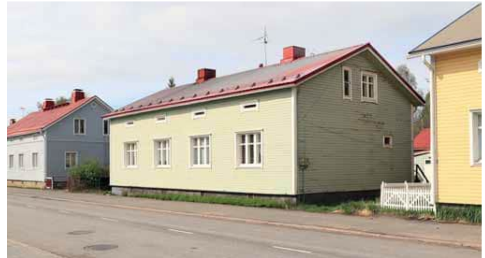
539. Verrattuna ylempään valokuvaan Teuvo Pakkalan katu 8 vesikate on uusittu profiilipeltikatteenä ja ullakon ikkunat suorina ja jaottomina. Pohjakerroksen ikkunat ovat voimakkaasti syvennyksessä. (Kuva: Riitta Kosonen, Arkkitehtitoimisto Jorma Teppo Oy, 5/2021.)
