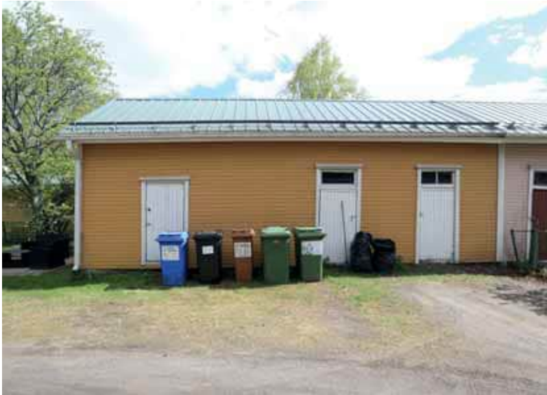
583. Karjakatu 17 piharakennusta on muutettu paljon. Piippu on purettu, ulko-ovet ja vesikate uusittu, kuisti rakennettu ja purettu sekä sisäänkäyntejä muutettu. (Kuva: Riitta Kosonen, Arkkitehtitoimisto Jorma Teppo Oy, 5/2021.)
