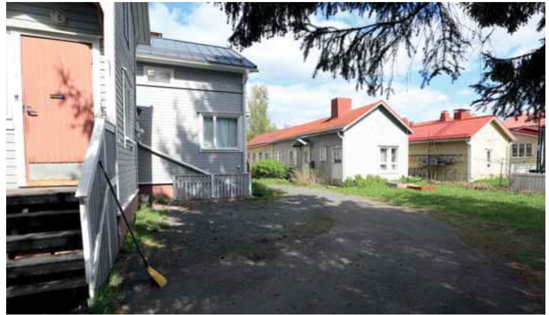
494. Karjakatu 11 pihan perusratkaisut ovat säilyneet. Ajo kellarin autotalliin on poistettu. Ulko-ovet on vaihdettu rakennuksen tyylistä poikkeaviksi. (Kuva: Riitta Kosonen, Arkkitehtitoimisto Jorma Teppo Oy, 5/2021.)
