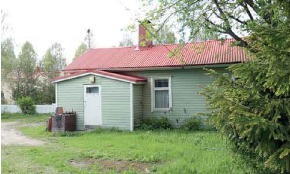
542. Piharakennuksen katto poikkeaa alkuperäisestä huopakatteesta. Kuisti ja ikkunat on lisätty jälkikäteen. (Kuva: Riitta Kosonen, Arkkitehtitoimisto Jorma Teppo Oy, 5/2021.)
