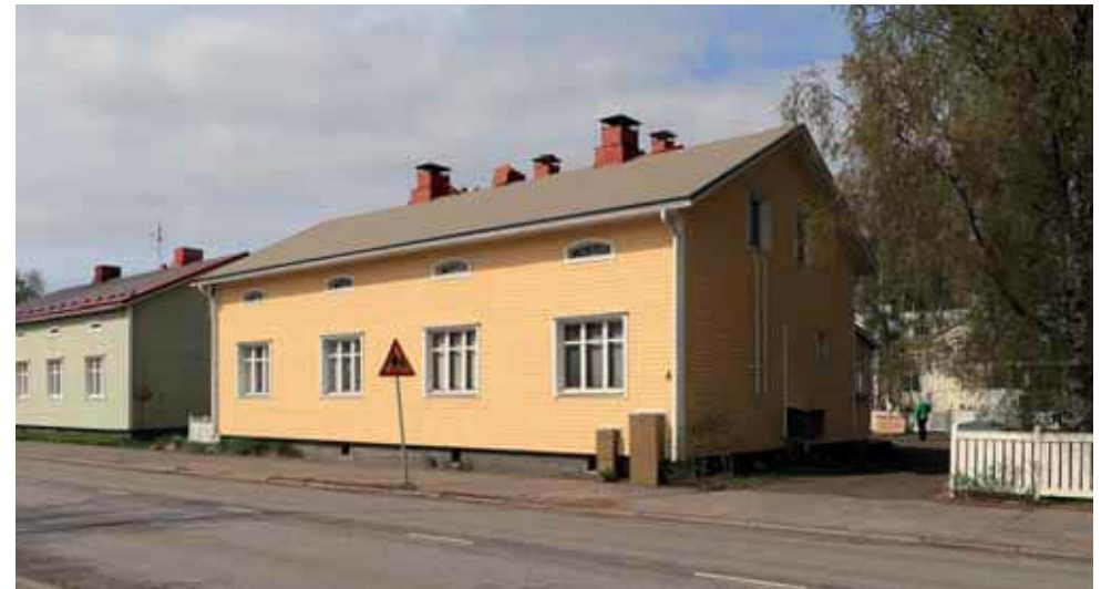
546. Teuvo Pakkalan katu 6:n julkisivussa on ulkopuolinen lisälämmöneristys, minkä johdosta ikkunat ovat jääneet voimakkaasti syvennykseen. Inventointi hetkellä oli käynnissä huopakaton uusiminen. Kuvassa näkyy alushuopa. (Kuva: Riitta Kosonen, Arkkitehtitoimisto Jorma Teppo Oy, 5/2021.)
