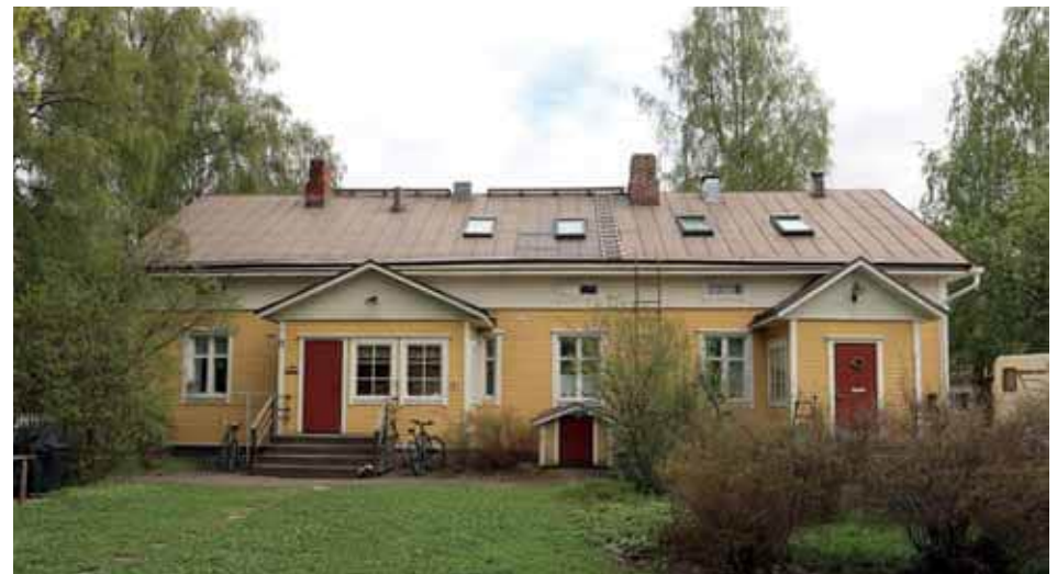
63. Ikkunat ja ulko-ovet on uusittu. Piha on kasvillisuudeltaan perinteinen marjapensaineen ja pihan perällä sijaitsevina kasvimaineen. Kulku kellariin on uusittu. (Kuva: Riitta Kosonen, Arkkitehtitoimisto Jorma Teppo Oy, 5/2021.)
