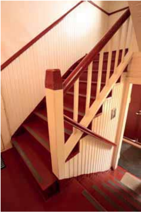
50. Syrjäkatu 11:sta puiset portaat johtavat toiseen kerrokseen. (Kuva: Riitta Kosonen, Arkkitehtitoimisto Jorma Teppo Oy, 5/2021.)
