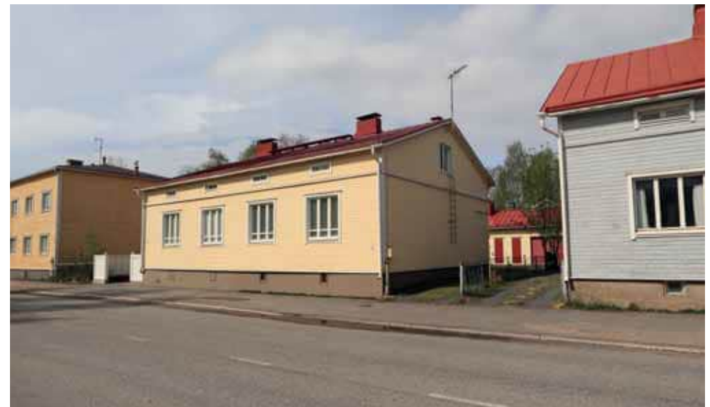
526. Katujulkisivun ja eteläpäädyn ominaispiirteet ovat säilyneet. (Kuva: Riitta Kosonen, Arkkitehtitoimisto Jorma Teppo Oy, 5/2021.)
