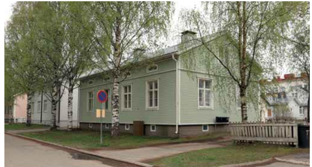
606. Karjakatu 23 katujulkisivun ominaispiirteet ovat säilyneet. Asuintilojen ikkunat on uusittu puittejako säilyttäen. Puitteiden dimensiot ovat lähellä alkuperäistä. (Kuva: Riitta Kosonen, Arkkitehtitoimisto Jorma Teppo Oy, 5/2021.)
