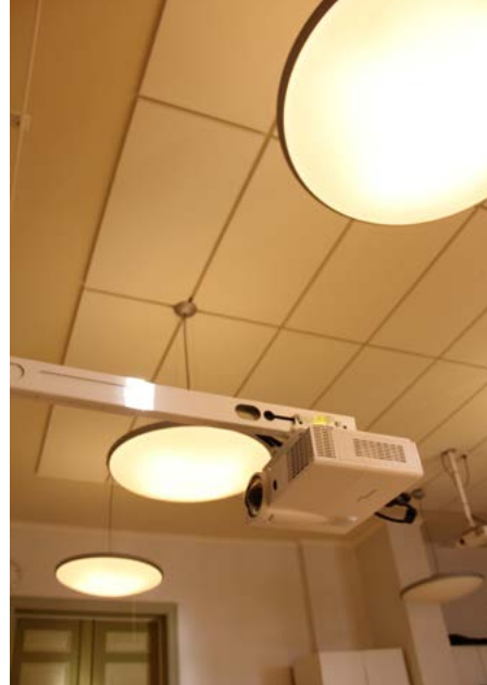
149. Ripustettuja plafondeja luokkahuoneessa.
