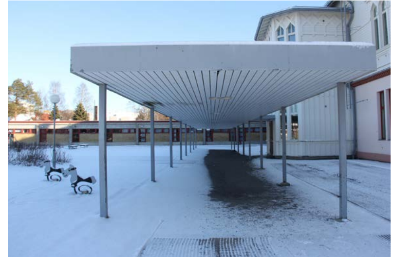
106. Sadekatos on muodoltaan ja mittasuhteiltaan historialliseen rakennukseen sopimaton.
