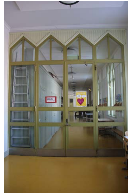
136. Käytävän teräsrunkoiset palo-ovet
