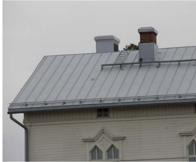
102. Alkuperäisten savupiippujen joukkoon on lisätty vasemmalla näkyvä ilmanvaihtokoneen poistohormi. Se on muotoiltu savupiipun muotoiseksi.
