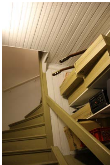
188. Ullakon porrashuone on verhoiltu helmiponttipaneelilla.
