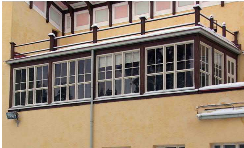
Kuva 72. Verannankaan ikkunapuitteet eivät alunperin olleet valkoiset vaan tummanruskeat, joko petsattua tai peittomaalattua puuta.
