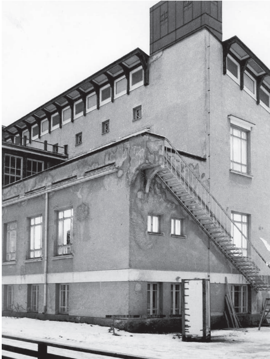
Kuva 21. Päärakennuksen julkisivut olivat ennen 1980-luvun alun perusteellista korjausta ikävissä kunnossa.
