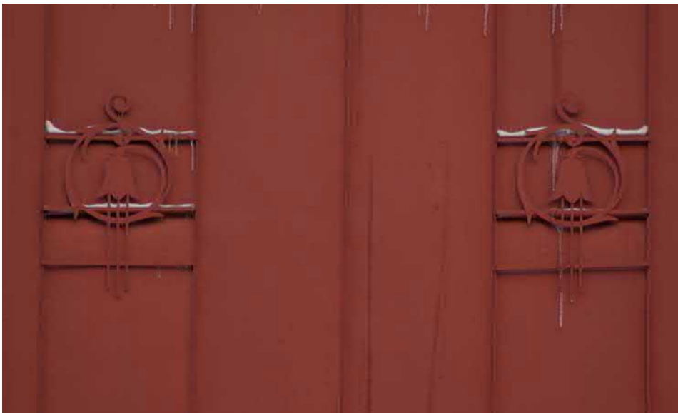
Kuva 69. Vesikaton päädyissä olevien hormien pellityksiin on toteutettu koristeaiheita.
