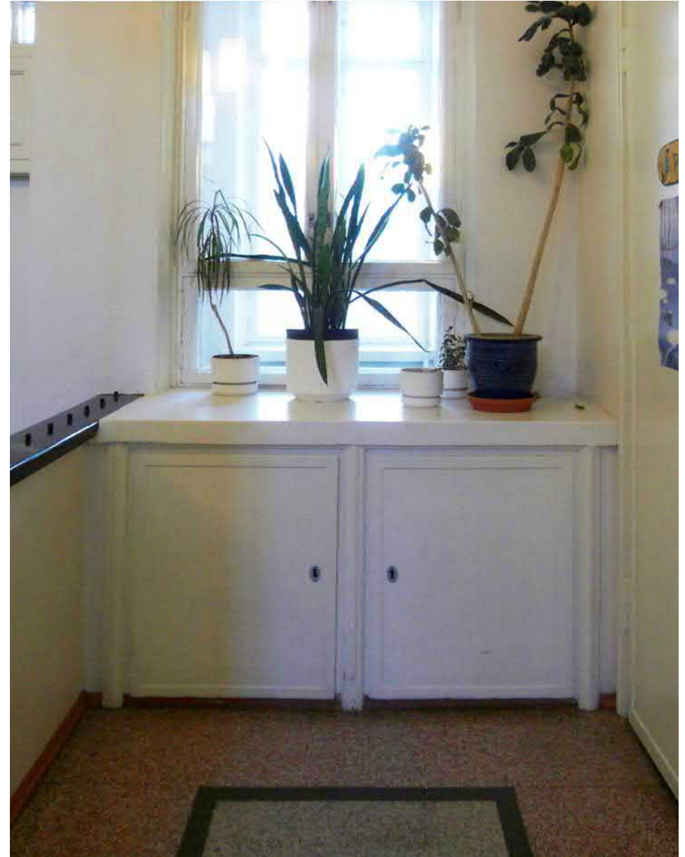
Kuva 67. Ensimmäisen kerroksen sisäänkäynnin molemmin puolin on kahdet kukkakaapit, jotka on työselityksen mukaan toteutettu rautabetonista ja puusta. Toinen kaapeista oli sisustettu pieniä siivouskaluja varten.
