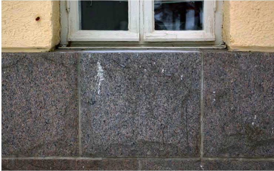
Kuva 71. Arkkitehti Sucksdorffin ohjeen mukaisesti ikkunan kohdalla oleva sokkelin luonnonkiven tuli olla molemmin puolin kymmenen senttiä lyhyempi kuin itse ikkunalle tehtävä aukko.
