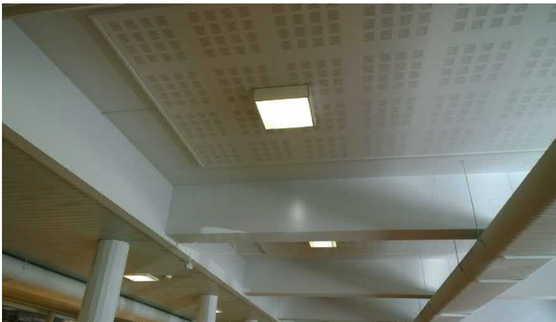
Ruokasalin alakaton materiaalina on huoneen laitaosilla alkuperäinen Dämpa-paneeli, huoneen keskiosan akustointilevyt on asennettu 2000-luvulla. Salin pitkittäissuuntaiset ilmanvaihtoputket rikkovat palkkien rytmityksen. (AS)
