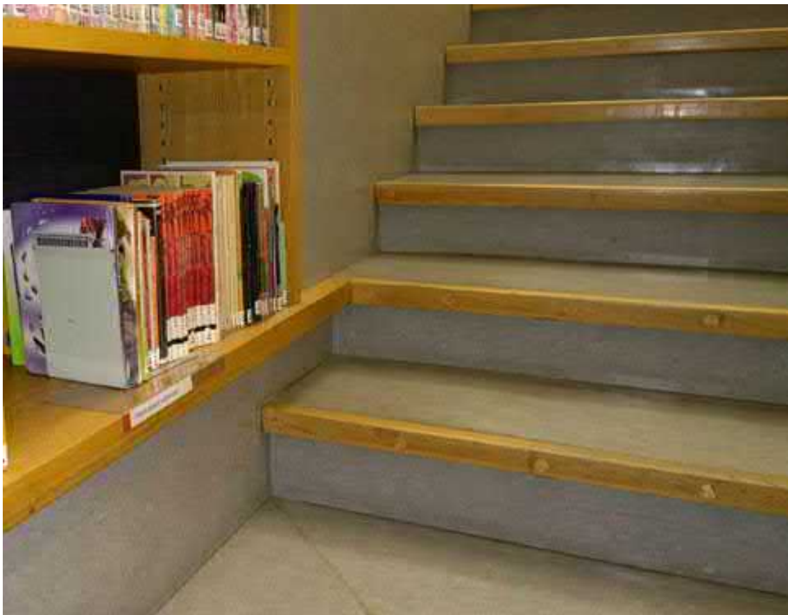
Linoleum-lattiapäällyste on osittain alkuperäinen. Uusimisessa on käytetty alkuperäisen kaltaista linoleumia. Tammisten listojen ja puisten kirjahyllyjen detaljointi kuvastaa Virralle ominaista huolellista yksityiskohtien suunnittelua. (AS)
