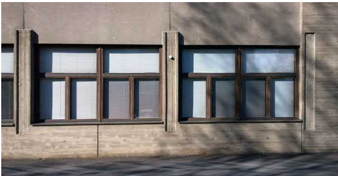
Arkkitehtoninen ilmaisu on voimakasta ja harkittua myös julkisivujen yksityiskohdissa, kuten pilasteriaiheen käsitte-lyssä. (AS)
