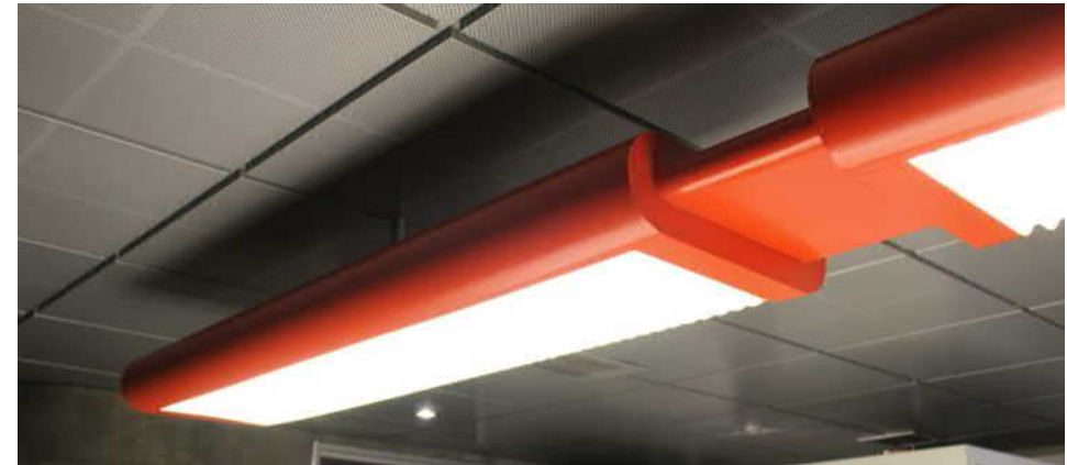
Pienen näyttämön lämpiön valaisimet ovat alkuperäiset. Vaatesäilytystilan kalusteet on peruskorjauksen yhteydessä uusittu.
