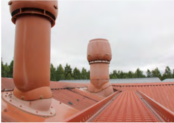
Ensikodin katolle lisättyä ilmanvaihtotekniikkaa.
