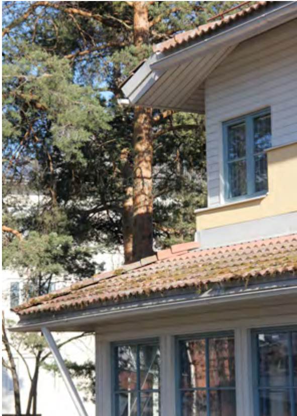
Turvakodin tiilikatto on sammaloitunut.
