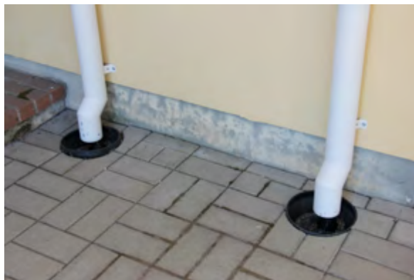
Hulevesijärjestelmä on uusittu 2009.
