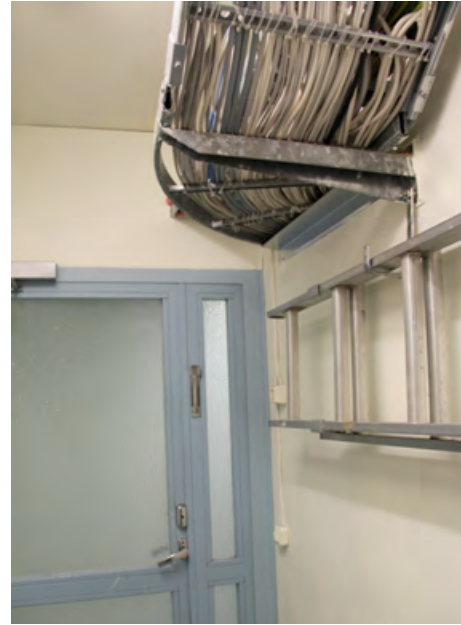
Kaapelihylly kellarin aputilan alakatossa.
