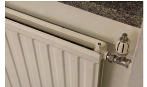
1990-luvulla uusittu lämpöpatteri ja termostaatti.
