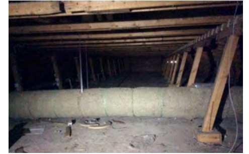
Eristetty ilmanvaihtokanava kylmällä ullakolla.
