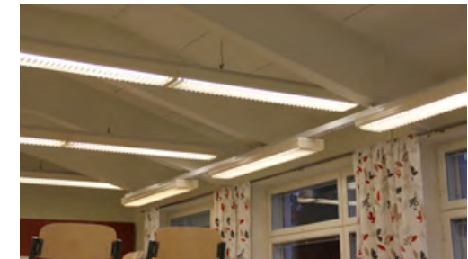
Jonovalaisimet kattopalkkien tasossa.
