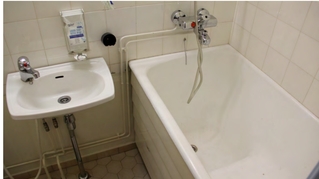
Talonmiehen asunnon vesikalustusta. Sekoittimet on uusittu 1990-luvulla koko rakennukseen. Istuma-amme on alkuperäinen.
