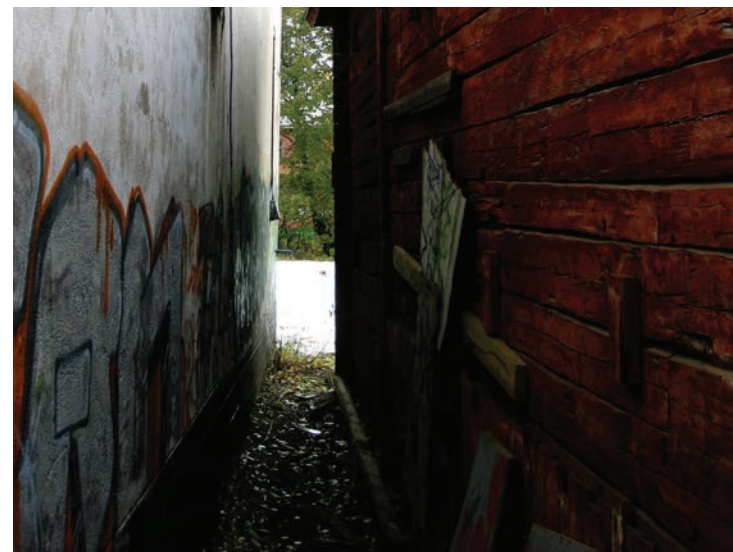
Kuva 144. Lähellä rakennettujen korjaamon (vas.) ja tallin väliin talvisin kasautuva lumi vaurioittaa niiden julkisivuja. AM.
