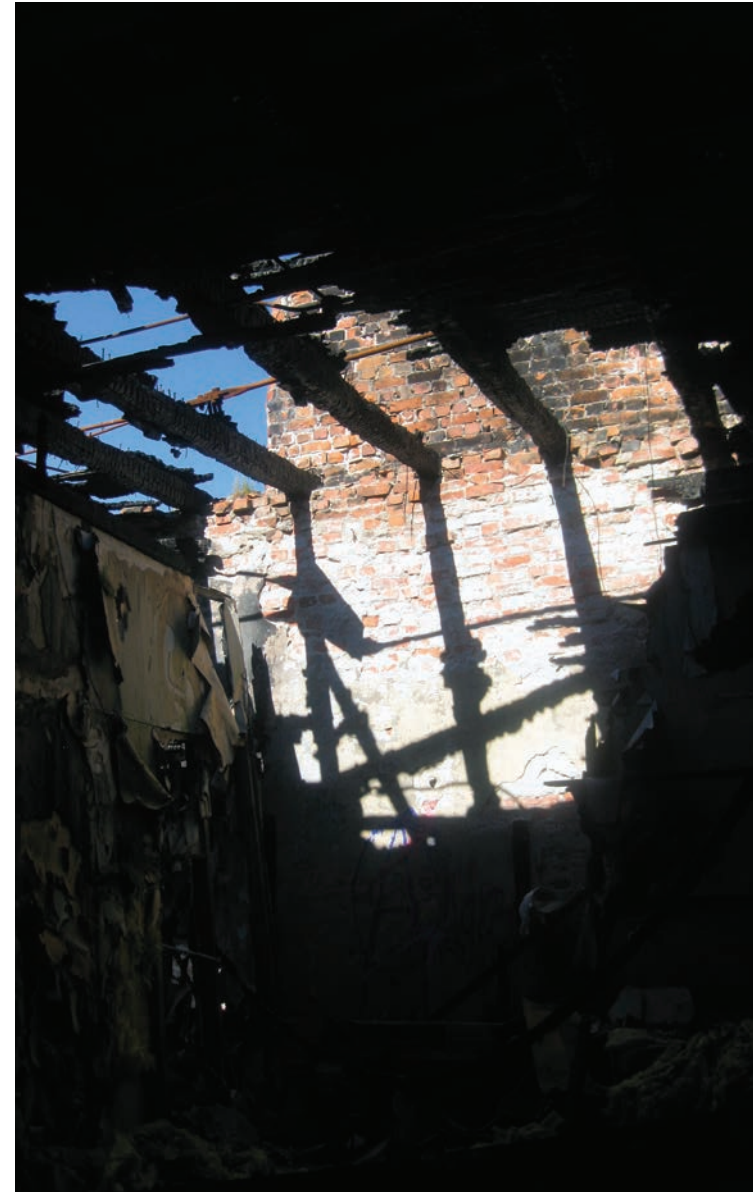
Kuva 120. Tulipalon tuhoama välipohjaa entisen konehuoneen kohdalla voimalan vanhimmassa osassa. AM.
