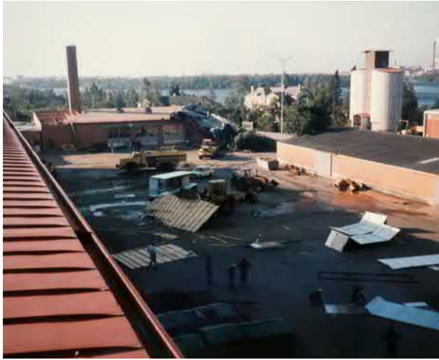
91. Vesikatto vuoden 1985 myrskytuhojen aikaan. Huoltohallin katto ja sen rakenteet jouduttiin uusimaan kokonaisuudessaan.
