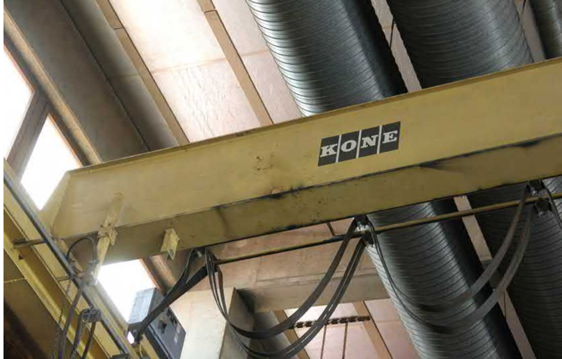
150. Korjaamon käytössä on päästä päähän kulkeva siltanosturi.
