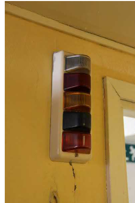
112. Liikennevalo kertoi, missä huoneessa lankapuhelin soi.
